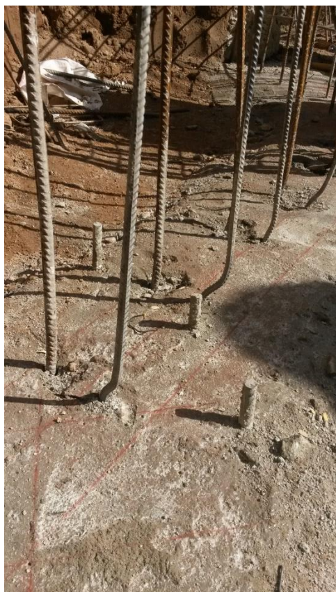
Figura 5.11: Armadura mal posicionada
