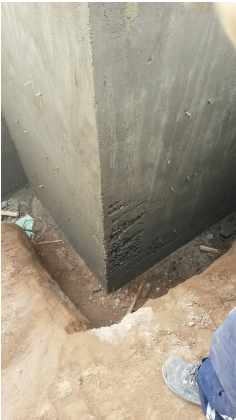
Figura 5.24: Oquedad en tabique
