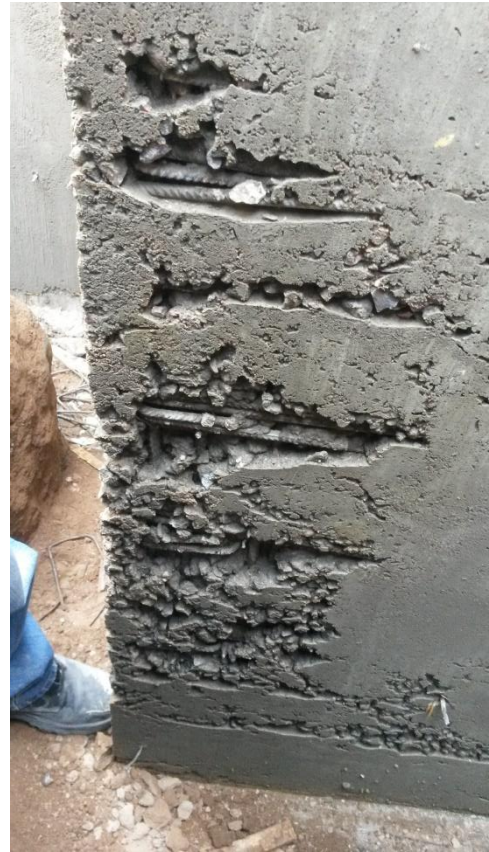
Figura 5.25: Oquedad en tabique
