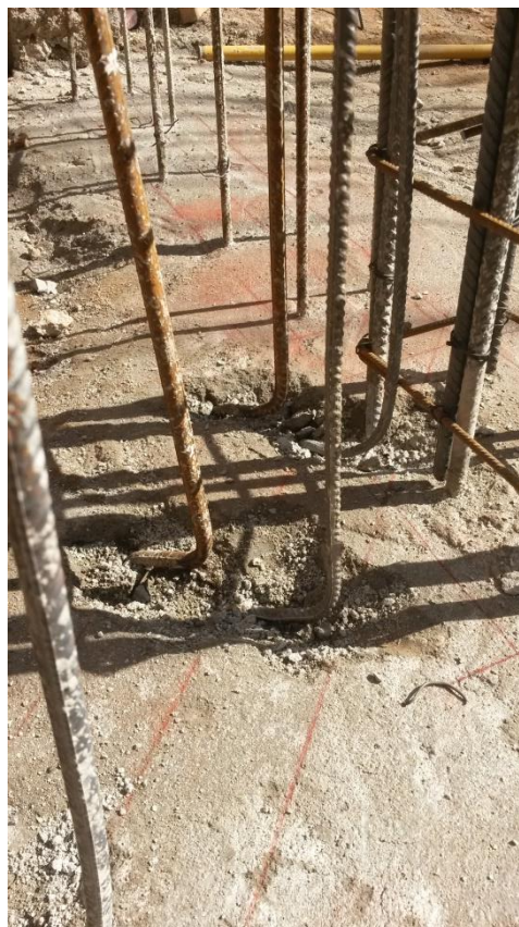
Figura 5.12: Armadura mal posicionada
