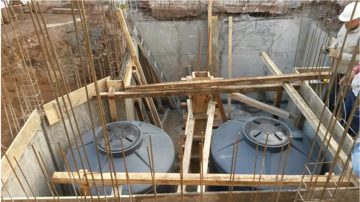
Figura 5.30: Cisternas de agua en subsuelo
