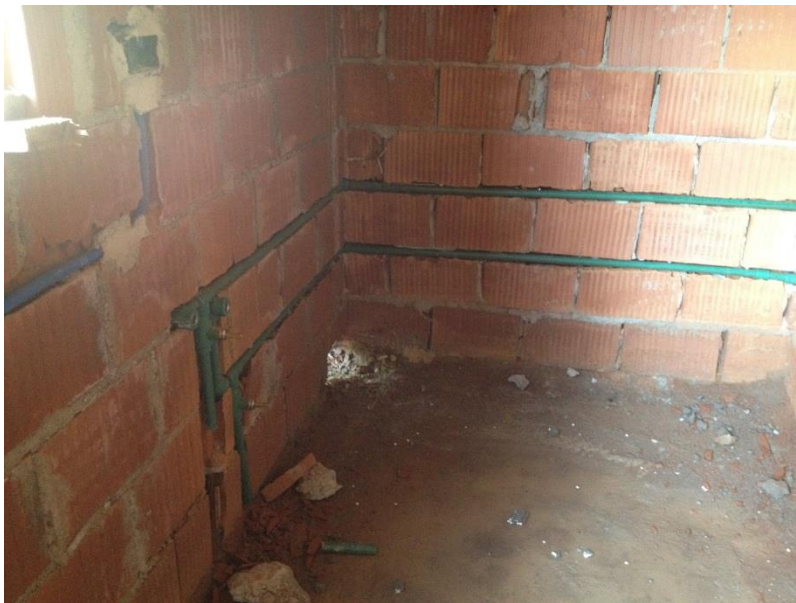
Figura 98: Instalación sanitaria de agua fría y caliente en baño
