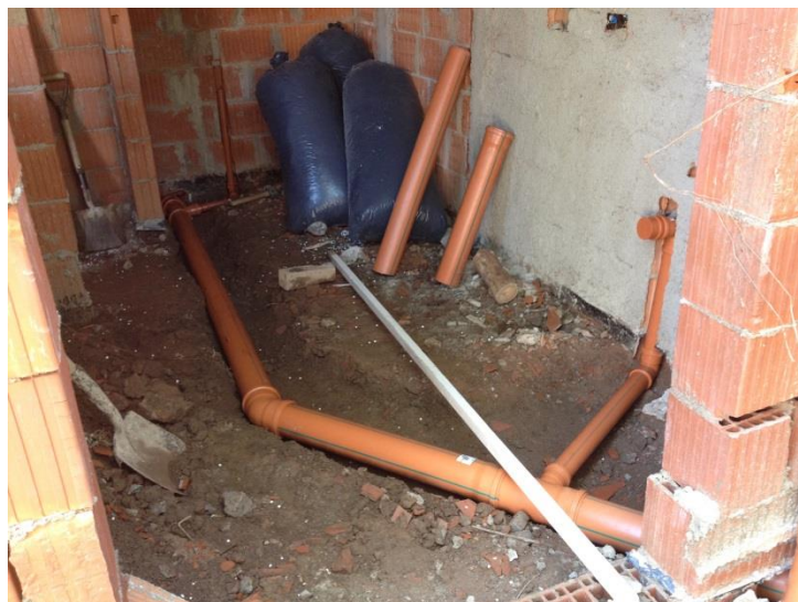
Figura 97: Instalación sanitaria cloacal de cocina
