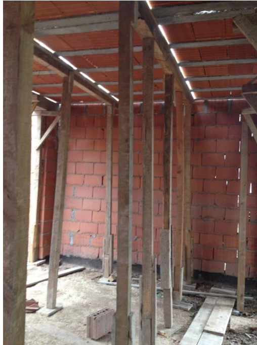
Figura 120: Apuntalamiento de nervios transversales utilizando puntales empalmados. Falta de riostra y cruz de san andres.
