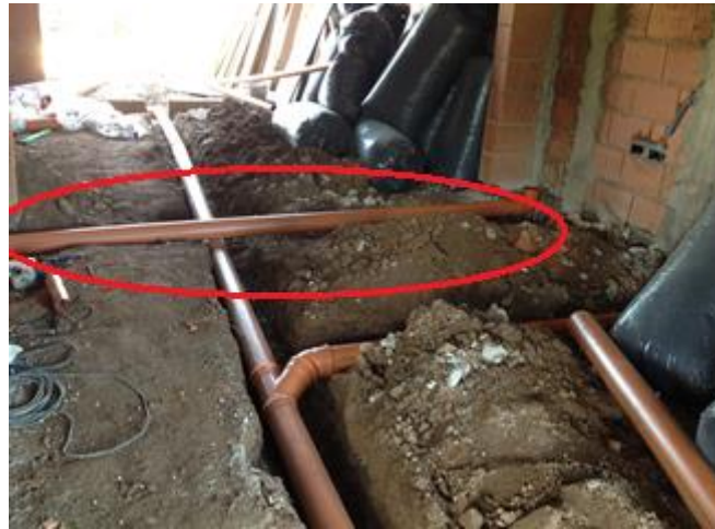
Figura 95: Cañería cloacal primaria
