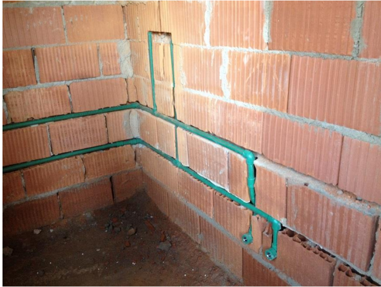
Figura 99: Instalación sanitaria de agua fría y caliente en baño
