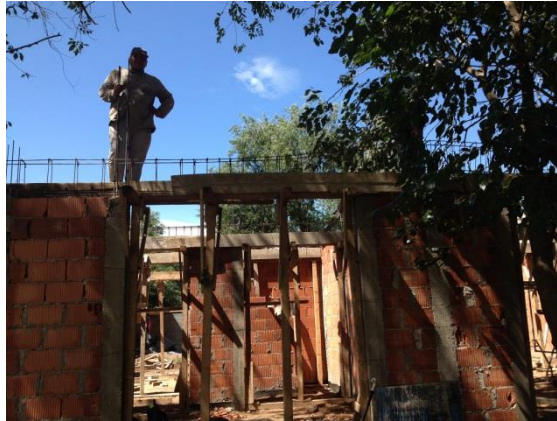
Figura 111: Trabajador colocando armadura de viga. Con ropa adecuada de trabajo pero sin casco, sin guantes, sin zapatos con punta de acero y sin protección contra caída
