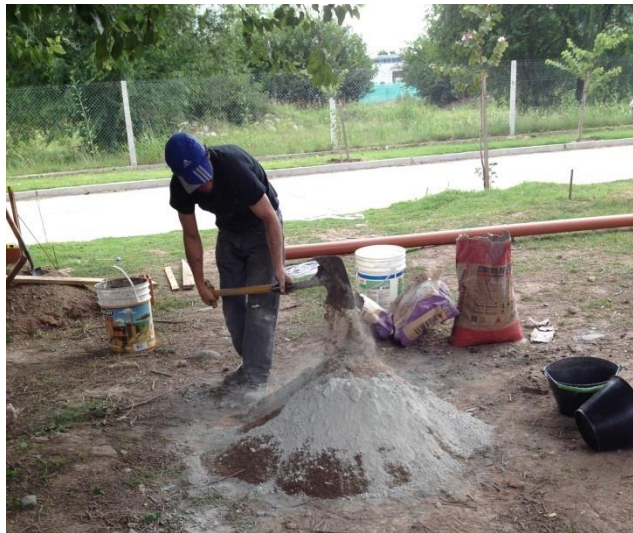
Figura 114: Preparación de mezcla. El trabajador no posee guantes ni ropa de trabajo. Tampoco una protección respiratoria ni ocular.
