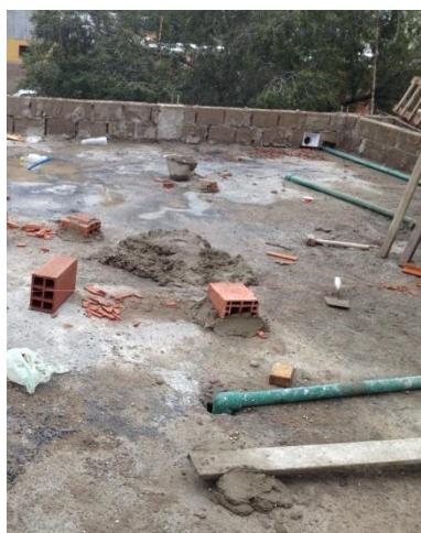
Figura 103: Instalación de agua caliente/fría, y pluvial.
