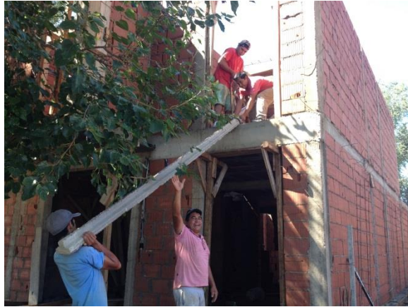
Figura 113: Manipulación de viguetas. No utilizan guantes, ni casco, ni ropa adecuada de trabajo. Los que están en el nivel superior no poseen elementos de protección contra caída.
