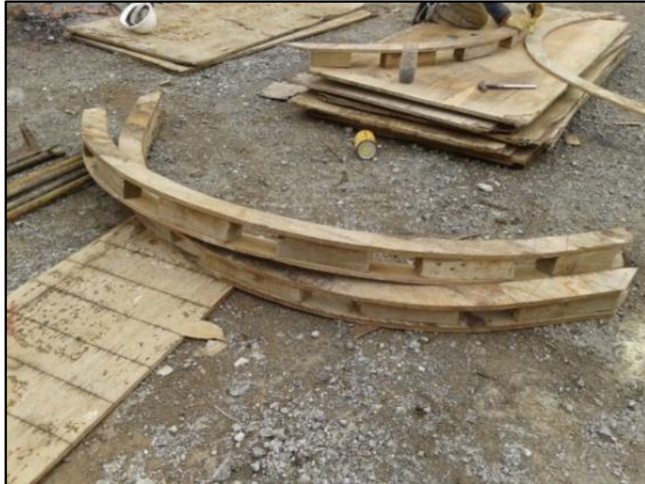
Figura N° 54: Costillas de madera.
