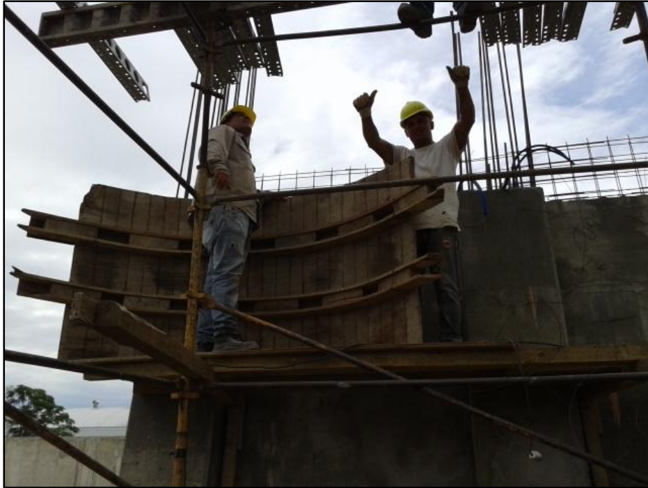
Figura N° 56: Costillas y fenólicos, que colocados unos al lado del otro cubrirán todo el tabique
