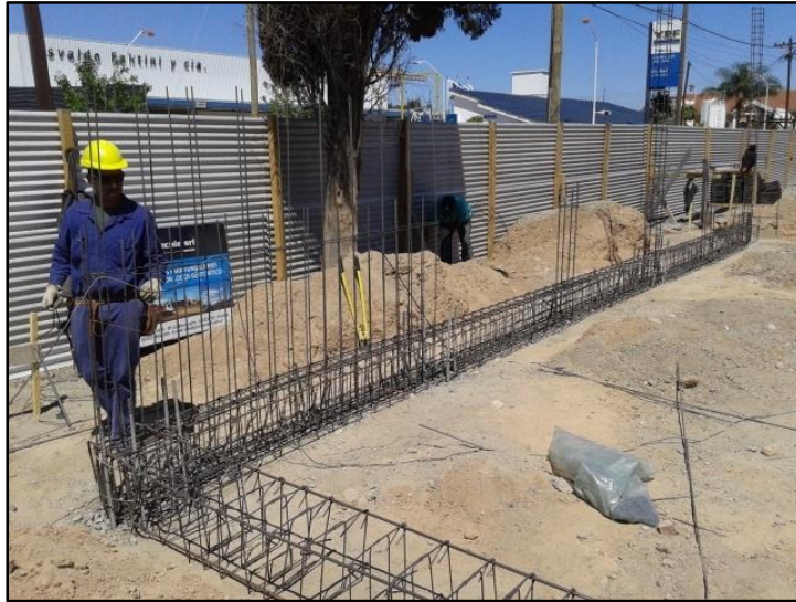
Figura N° 28: Imagen donde se aprecia cómo se fue replanteando y colocando los primeros tramos de tabiques y columnas.
