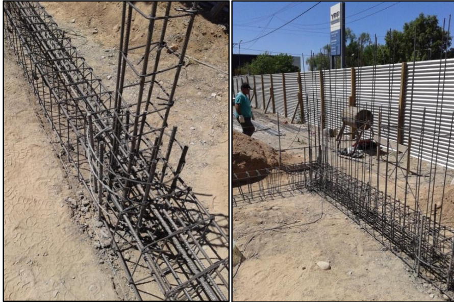
Figura N° 44: Replanteo y presentación de las columnas y tabiques en la armadura de las vigas.
