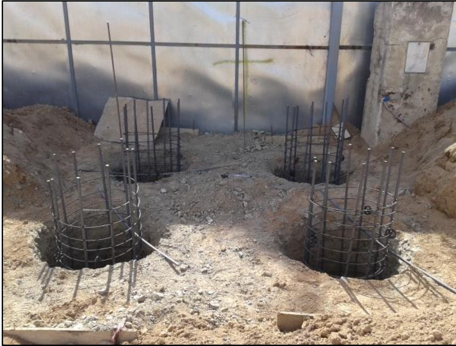
Figura N° 66: Pozos que pertenecen al cabezal.
