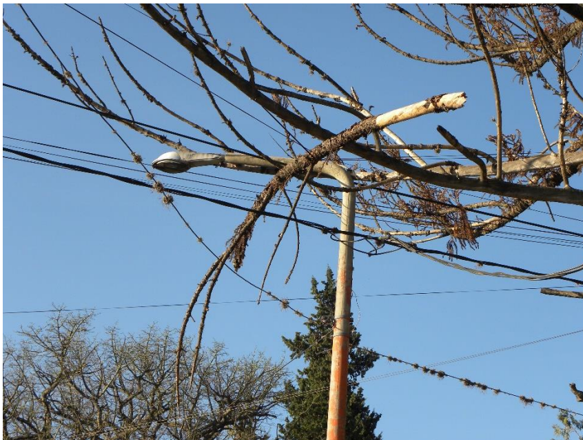
Figura I.1. Rama atravesada sobre los cables de energía eléctrica, lo que implica riesgos de cortocircuitos, incendios, etc. Existe responsabilidad del Estado por permitir el cableado aéreo.
