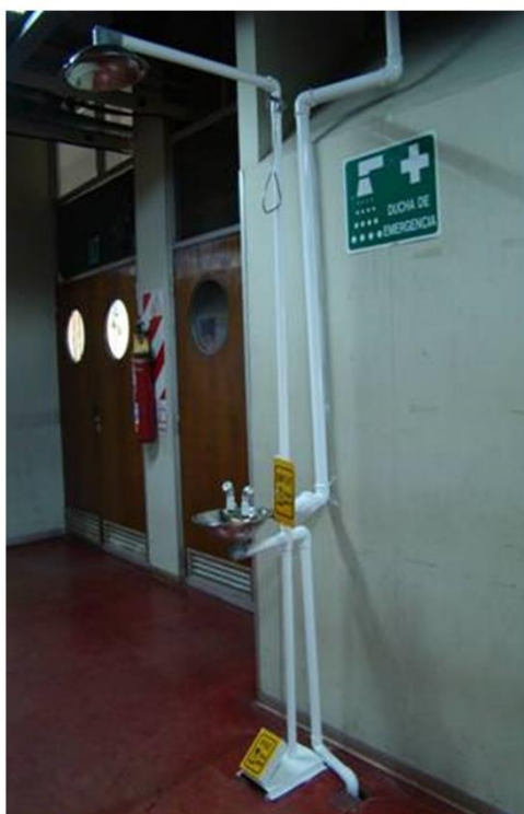
Figura I.6. Ducha de emergencia y baño de ojos. Pasillo contiguo a los laboratorios de enseñanza, Facultad de Ciencias Químicas, UNC. Área Centralizada de Actividades Prácticas, Facultad de Ciencias Químicas, UNC.
