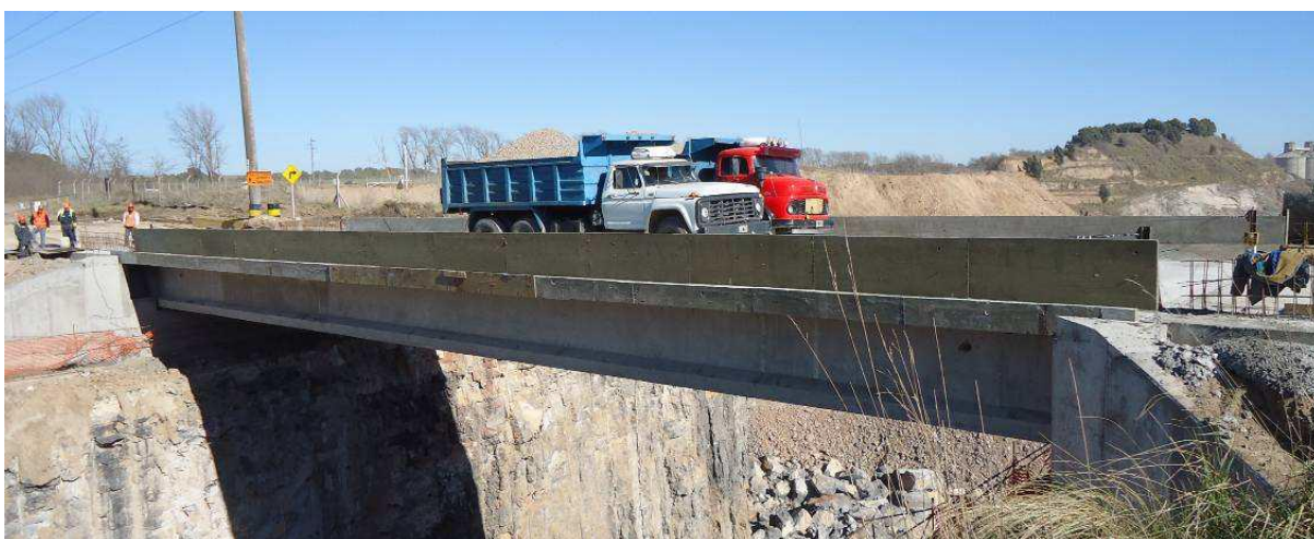
Figura 2: Instancia de la Prueba de carga con dos camiones (1er. Escalón de carga)
