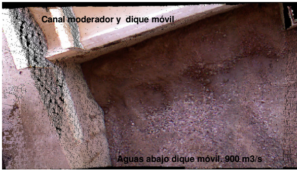
Fig. 7: Foso de erosión aguas abajo del dique móvil. Imagen RGB.
