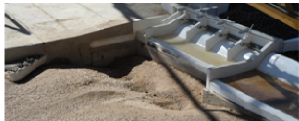
Fig. 6: Foso de erosión aguas abajo del dique móvil. Caudal: 900 m 3 /s
