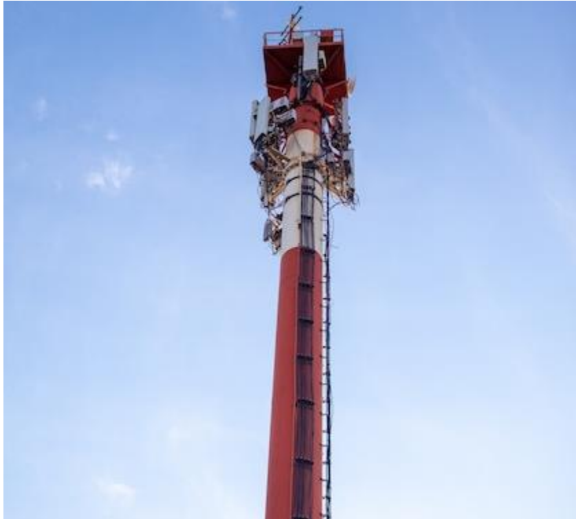
Figura 0.10. - Torre monopolo sección superior
