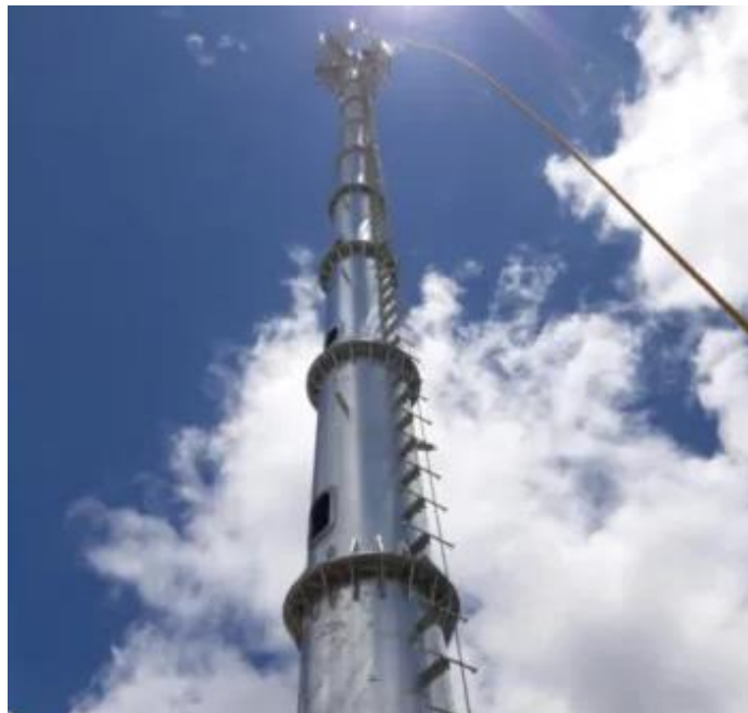
Figura 0.9. - Torre monopolo de acero galvanizado
