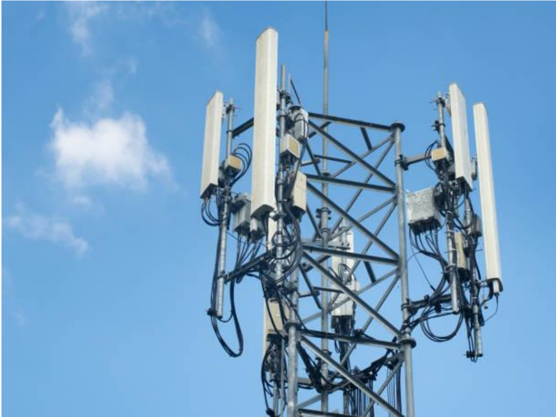
Figura 0.13. – Antenas para radio frecuencia
