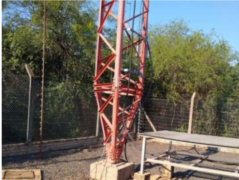
Figura 0.8. - Base central de torre atirantada
