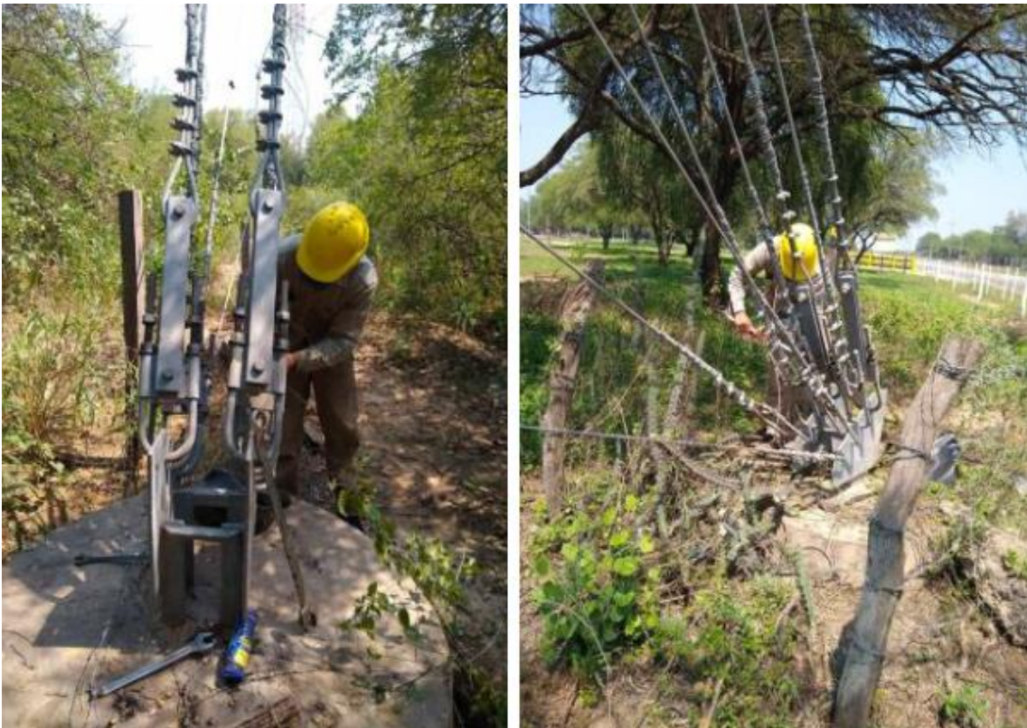
Figura 0.7. - Anclajes de riendas de torre atirantada
