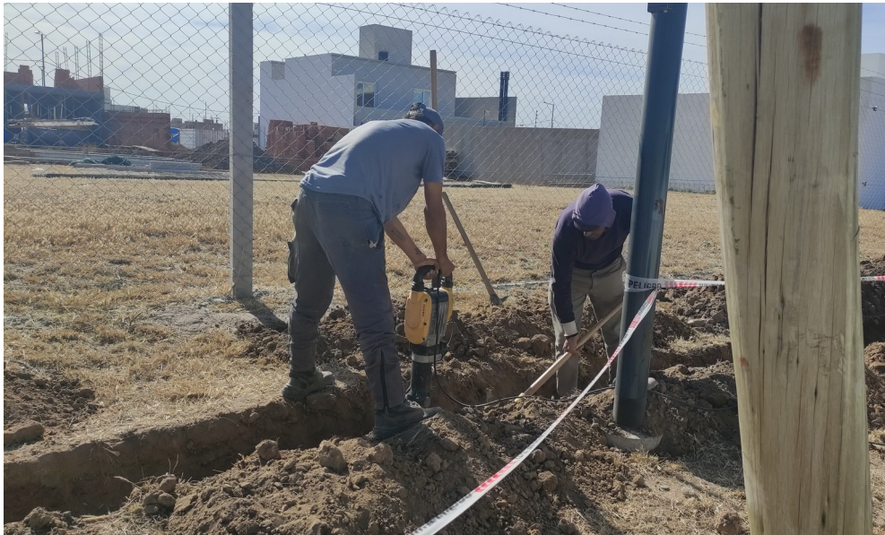
Figura 40: Empleo de martillo eléctrico para fragmentar el terreno
