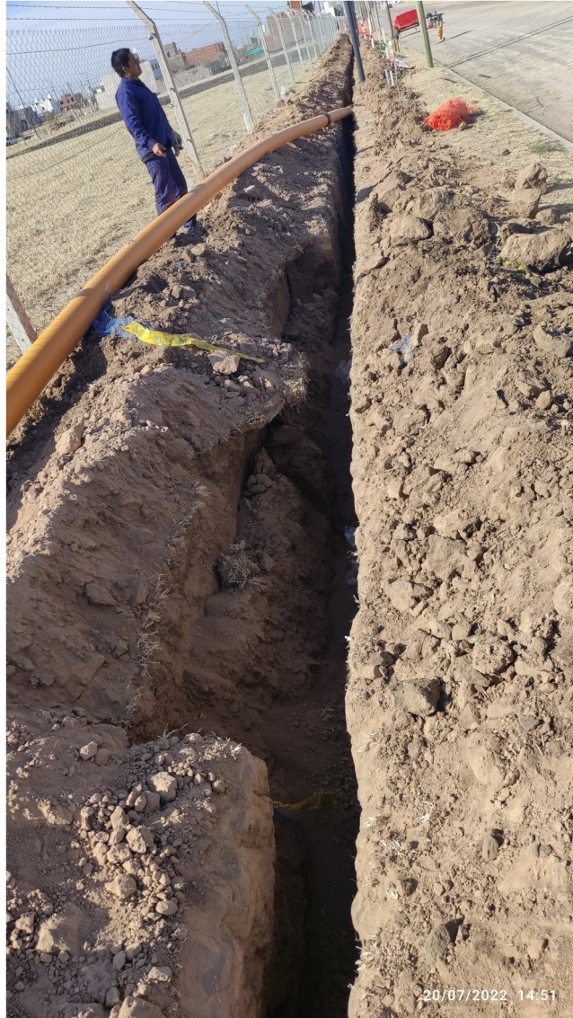
Figura 43: Desmoronamiento de zanja debido a rotura de servicio
