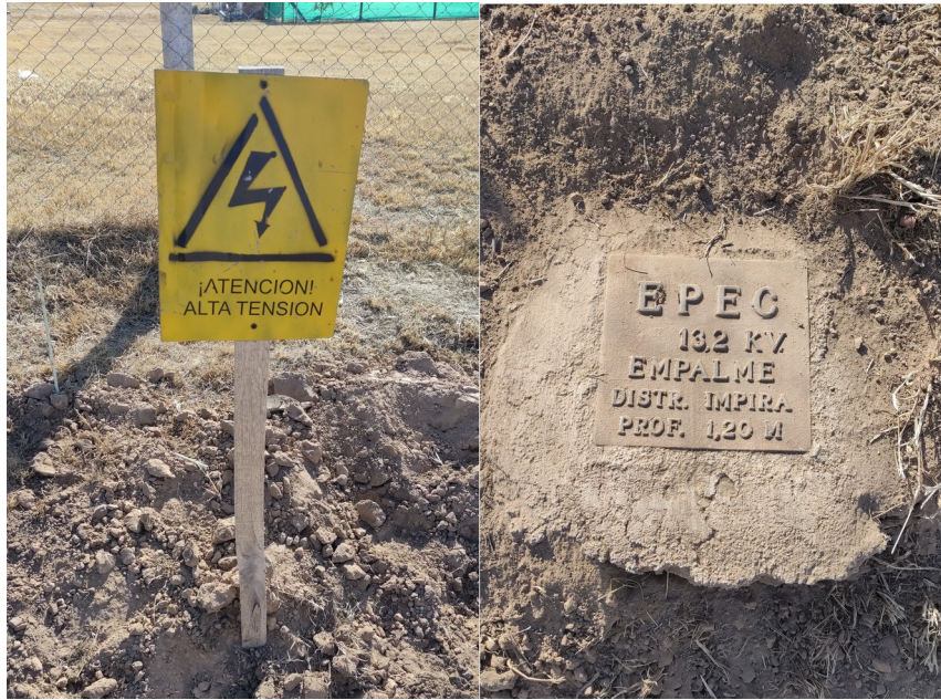
Figura 44: Cartel de advertencia EPEC - Caja EPEC
