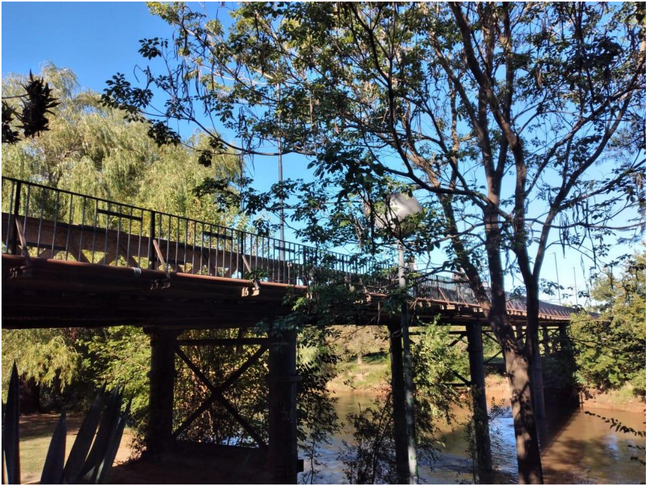
Imagen N° 40: Puente Isidro Fernández Nuñez, el cual une los barrios La Floresta (Villa Nueva) y Santa Ana (Villa María). Fuente: elaboración propia (2021).
