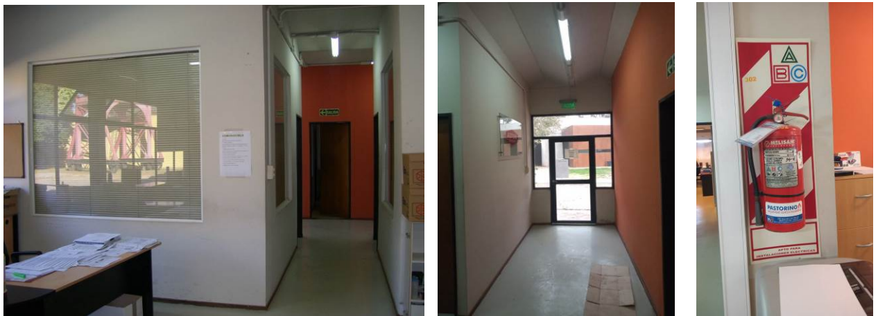
FIGURA N°25 – N°26– CARTELERIA SALIDA DE EMERGENCIA Y MATAFUEGO CON BALIZA
