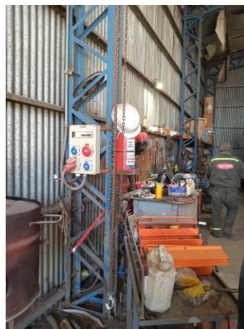
FIGURA N°52 – UBICACIÓN DEL TABLERO ELECTRICO Y MATAFUEGO
