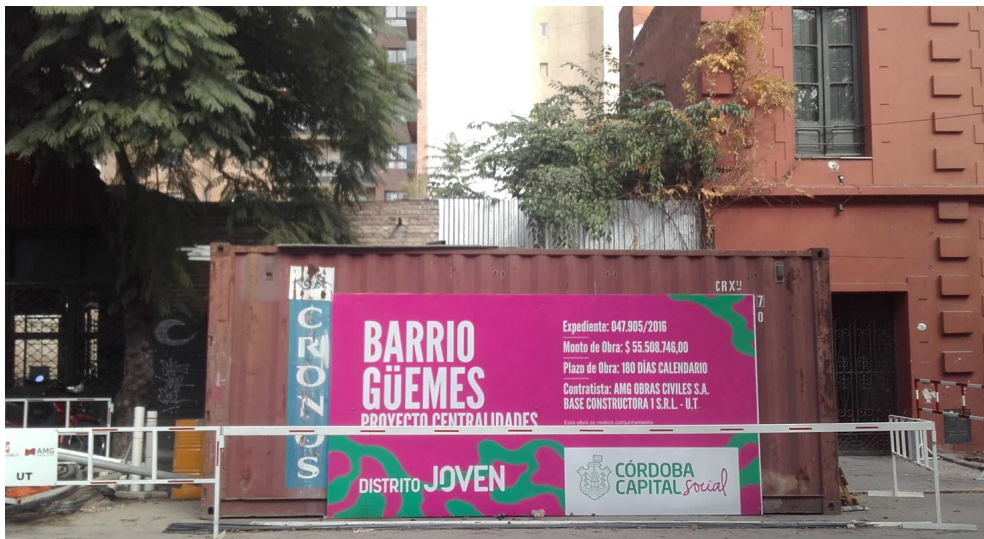
Figura 55: Obrador del Proyecto de nuevas centralidades, Distrito joven en calle Fructuoso Rivera al 200
