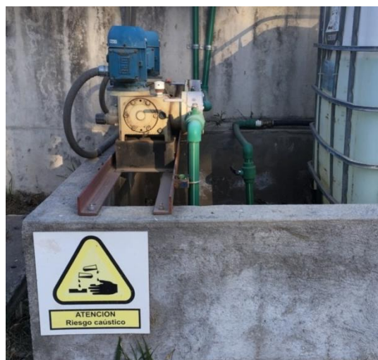
Ilustración 9: Cuba de contención del Hidróxido de Sodio en planta Suquía.
