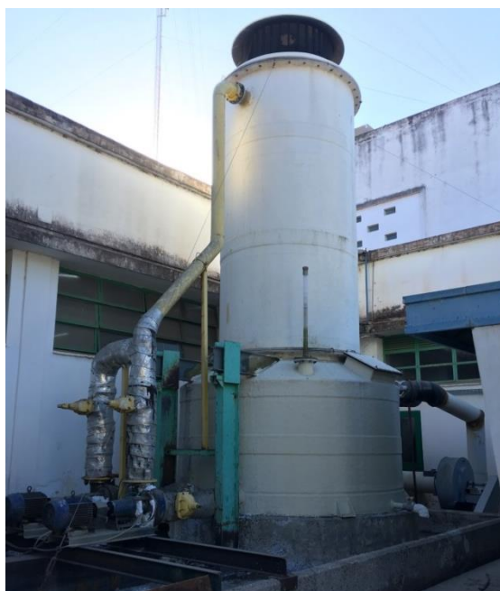
Ilustración 13: Torre neutralizante de fuga de Cloro en planta Suquía.
