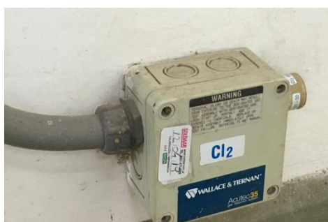
Ilustración 16: Sensor de niveles de Cloro.
