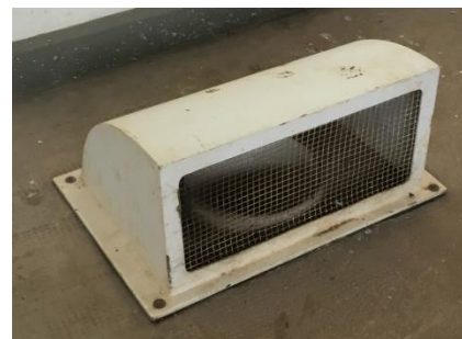
Ilustración 17: Toma de fuga de Cloro dirigida a las torres neutralizantes.
