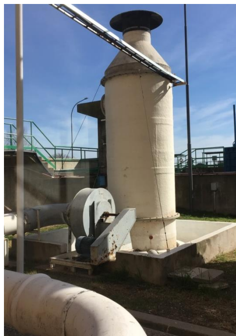
Ilustración 14: Torre neutralizante de fuga de Cloro en planta Los Molinos.
