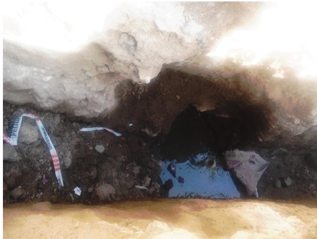
Figura 6.11: Desborde de ramal domiciliario
