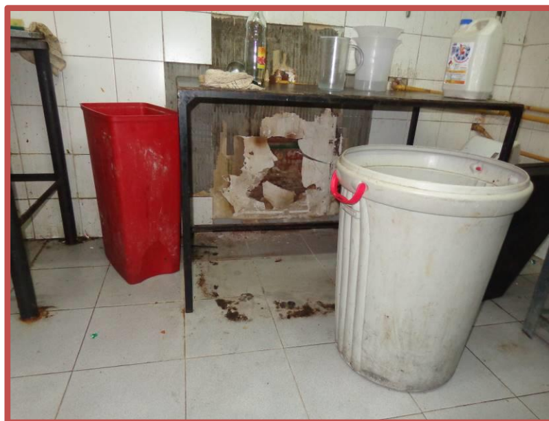
Figura 4.2.7 – Cocina Subsuelo, pared medianera con desprendimiento de cerámicos
