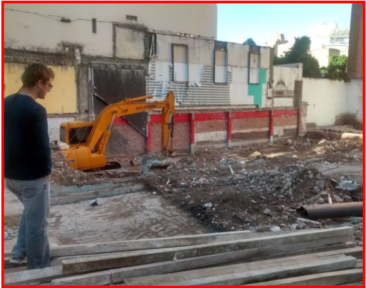
Figura 4.6.2.7 – Construcciones de Bucor y Hawai totalmente demolido
