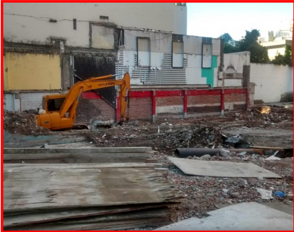
Figura 4.6.2.5- Construcciones de Bucor y Hawai totalmente demolido
