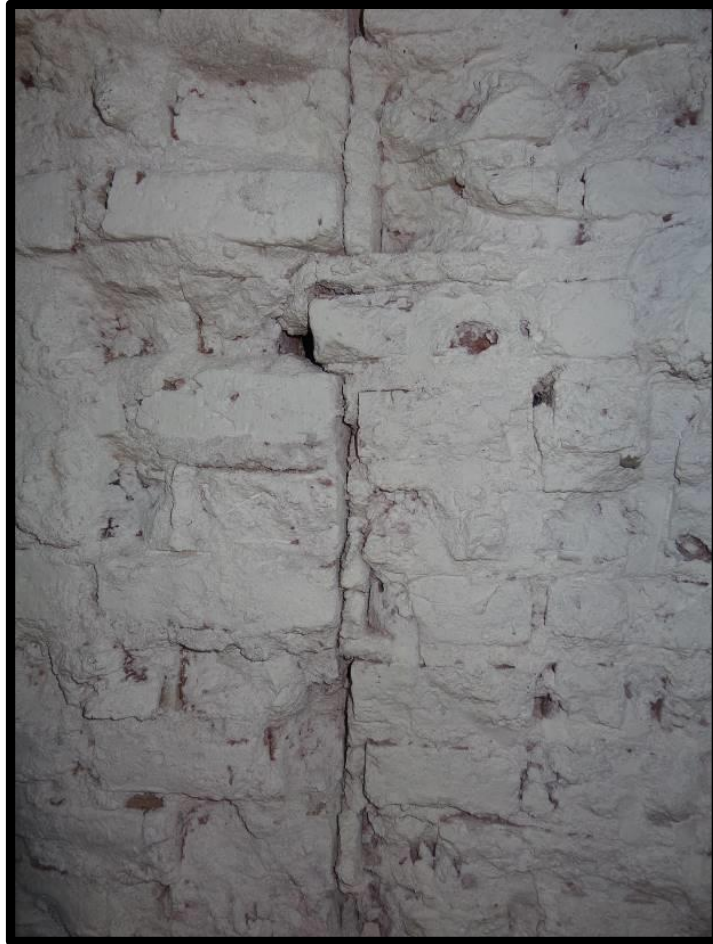
Figura 4.2.4 – Movimiento Relativos, aparición de Fisuras en paredes.
