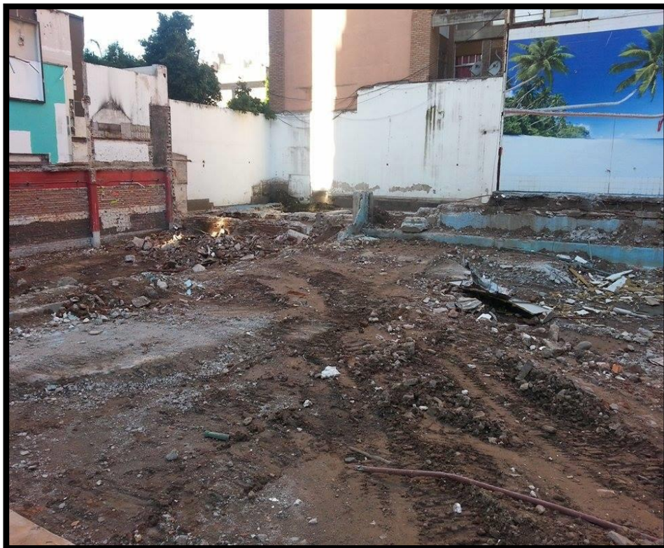
Figura 4.6.2.6- Construcciones de Bucor y Hawai totalmente demolido
