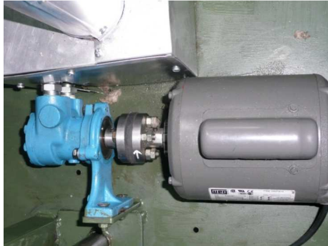
Figura 3.16: Imagen superior de la bomba de aceite térmico.
