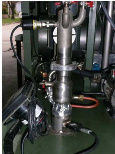
Figura 3.12: Bomba difusora con sensor de presión de alto vacío.
