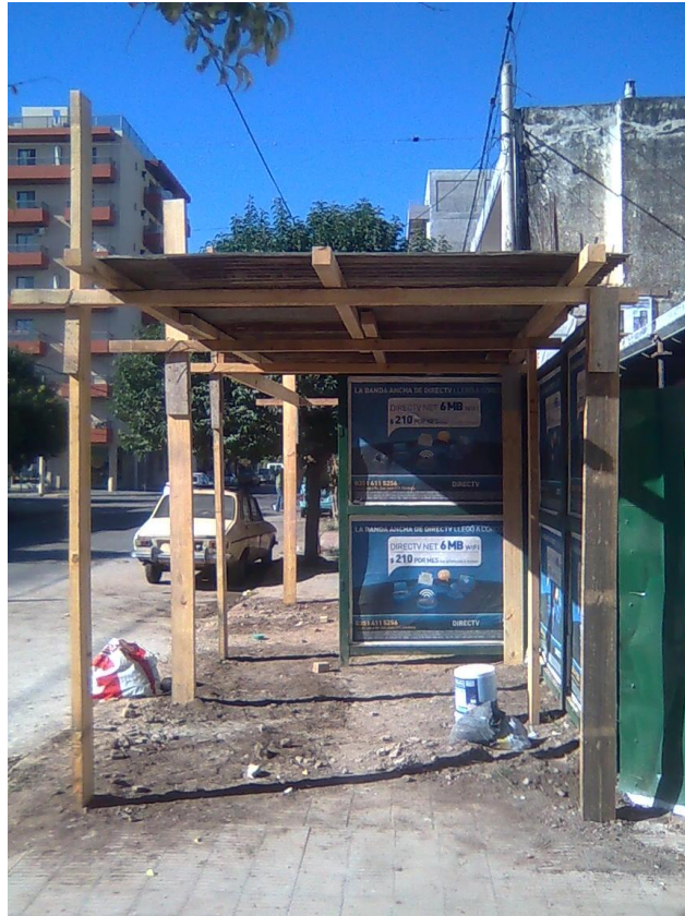
Fig. 69_Bandeja de seguridad, frente de edificio.
