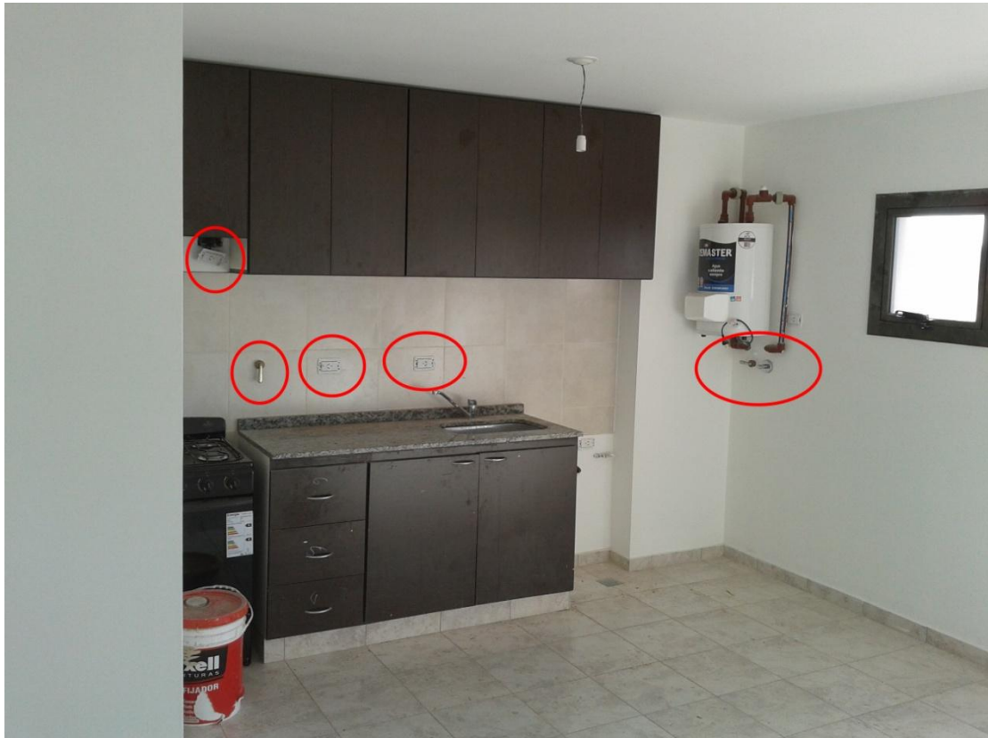
Fig. 13_Detalles de llaves eléctricas y de gas faltantes.
