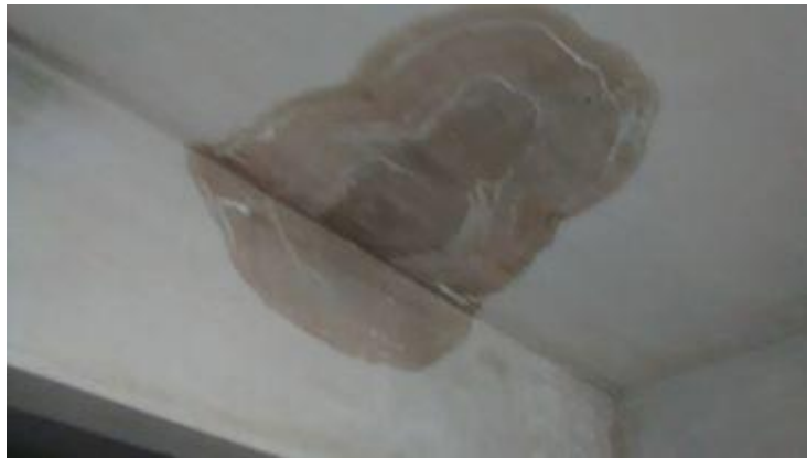
Fig. 6_Mancha de humedad en el techo.
