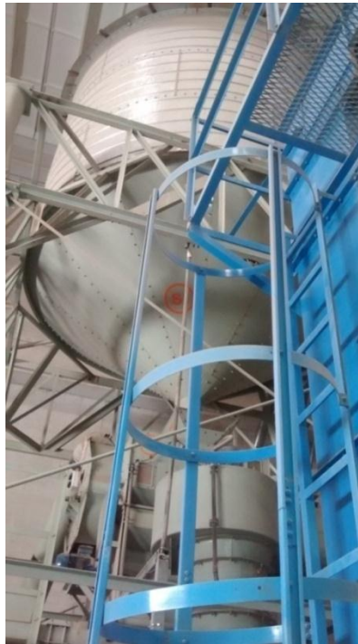
Figura 10: Tolva principal que almacena los granos provenientes de los silos pulmón que se encuentran fuera de la planta.
