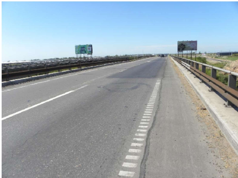
Figura 2.9. Vista de la calzada de uno de los puentes sobre la autopista de la Ruta Nacional N° 9.
