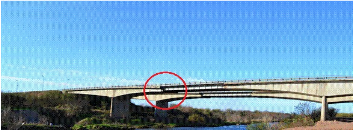
Figura 2.16. Foto del descenso en la unión de la parte de hormigón con la parte metálica, causante de la variación en la pendiente de la rasante del puente.
