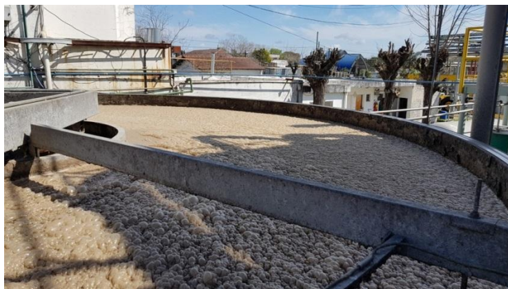
Figura 2. 18 - Tanque de flotación (DAF).
