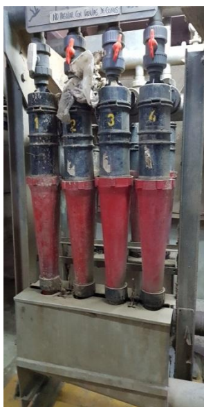
Figura 2. 4 – Batería de hidrociclones
