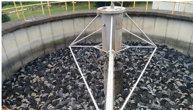
Figura 2. 24 - Filtro percolador con relleno polimérico
