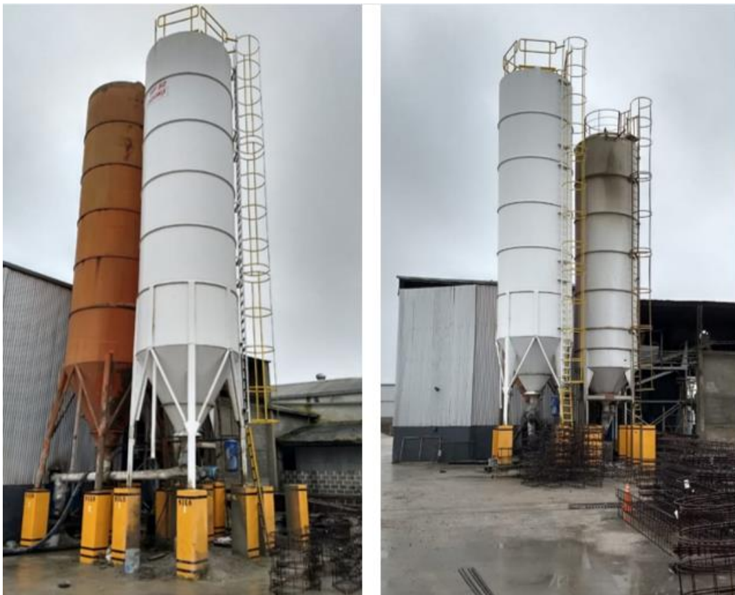
Imagen 2.14. Silos de almacenamiento de cemento en Hormicoop.
