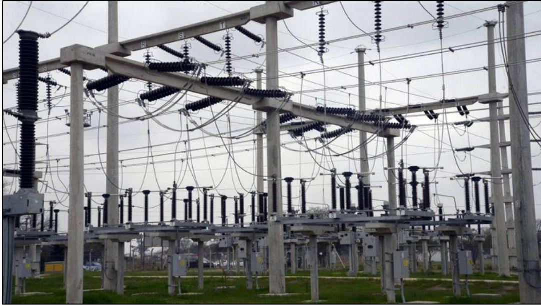
Imagen 1.2. Estación Transformadora Las Varillas, cuyos accesorios y postes fueron provistos por Hormicoop.
