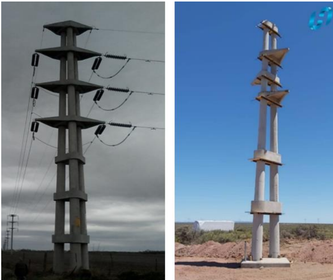
Imagen 1.4. Estructura triple y doble para distribución de energía.
