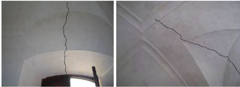
Figura 11: Sector de habitación D9 con fisuras
