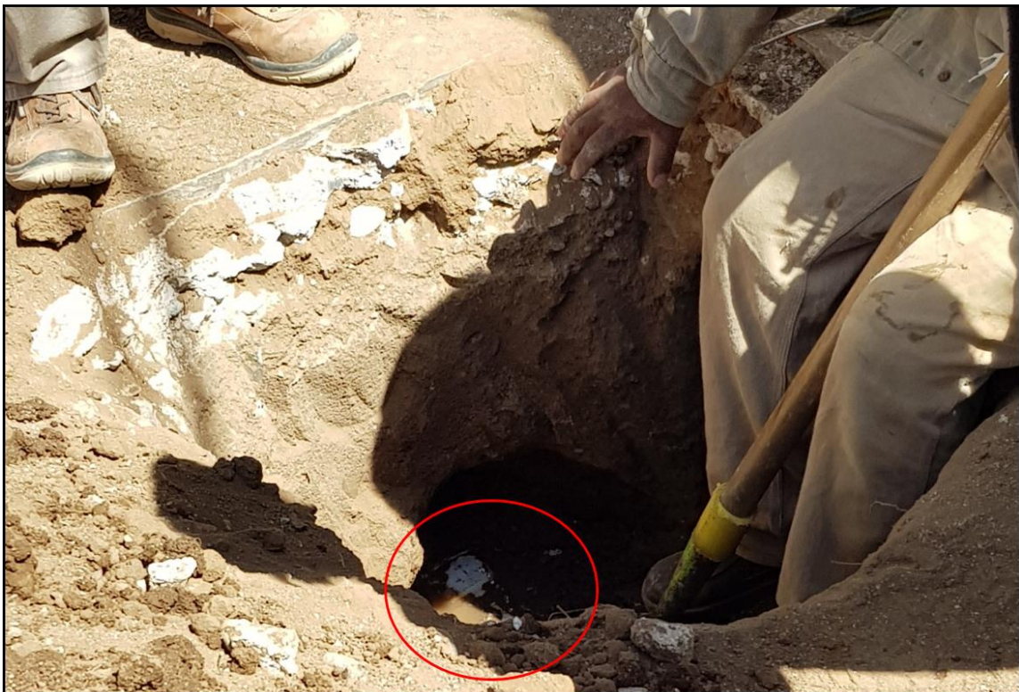
Figura 4.2.9.1 – Tramo de cañería fisurado (Fuente: Elaboración propia)
