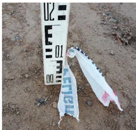
Figura 25: Verificación del espesor de la losa una vez nivelado el clavo de hierro.
