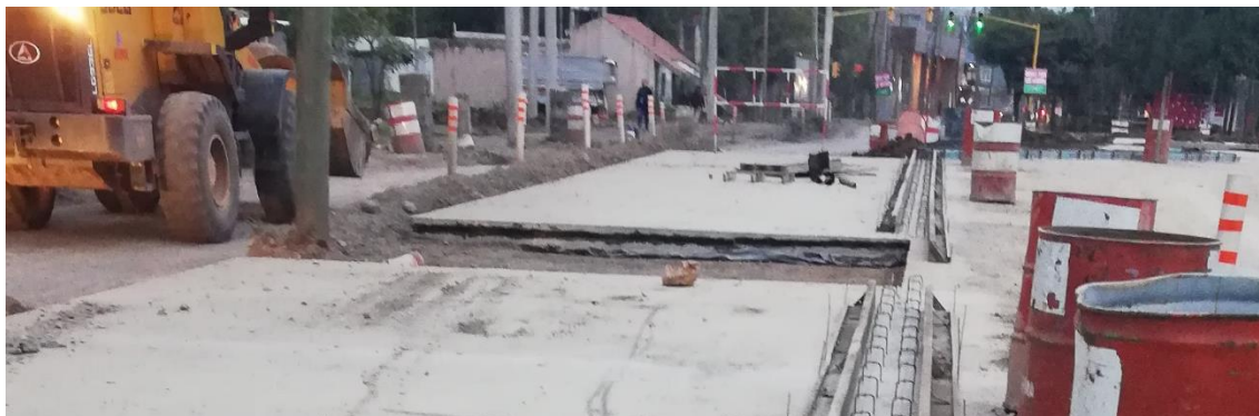
Figura 48: Losas hormigonadas y no hormigonadas debido a la no reubicación del servicio.
