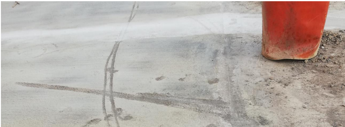
Figura 50: Daño causado en losa de hormigón por el paso de una bicicleta y motocicleta.
