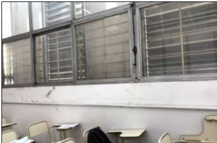
Fotografía 8. Detalle del estado de las paredes y la falta de mantenimiento de los elementos para poder abrir y cerrar los parasoles como así también las ventanas.
