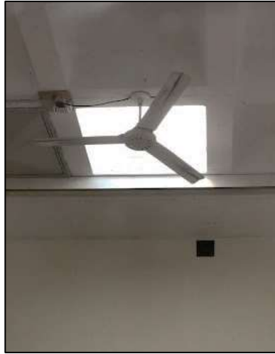
Fotografía 71. Conexión eléctrica nueva y vieja, en donde se puede ver la diferencia de materiales. En la fotografía de la derecha se muestra como los ventiladores tienen asignada la velocidad de funcionamiento.
