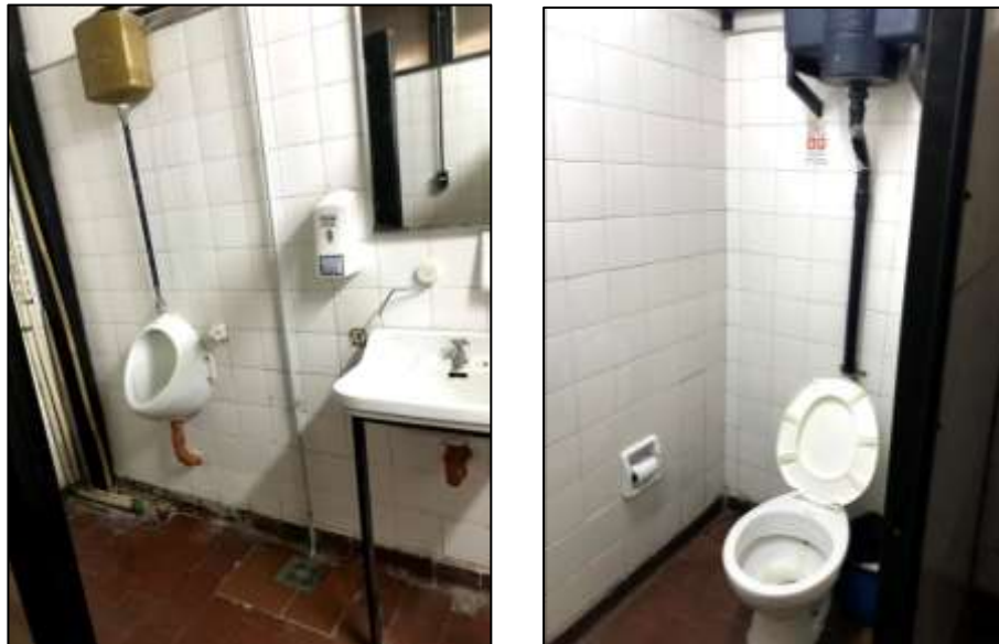
Fotografía 16. Instalaciones sanitarias, inodoro, mingitorio, mochilas de los mismos e instalaciones de agua.
