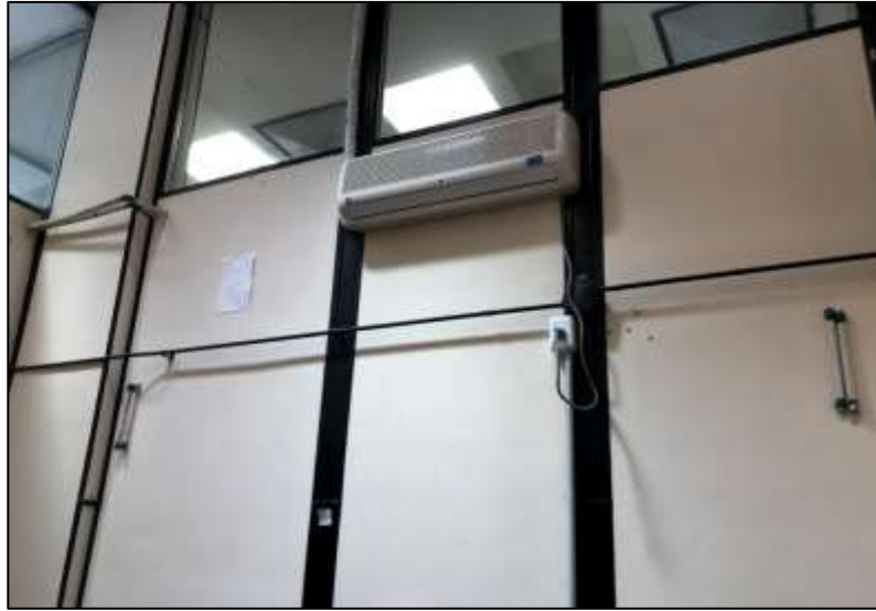
Fotografía 23. Elemento de refrigeración del local, donde se muestra la instalación eléctrica vieja del local. Además se puede observar las dimensiones de los paños fijos de la parte superior de las paredes.
