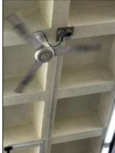
Fotografía 80. Ventilador del aula, el cual como puede observarse tiene determinada la velocidad a la cual deben funcionar.
