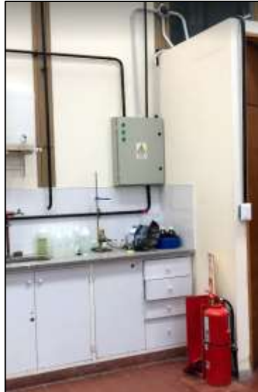
Fotografía 59. Cesto de recolección de plásticos, matafuego, tablero eléctrico. Se puede apreciar parte de la instalación eléctrica nueva y así mismo la parte antigua.
