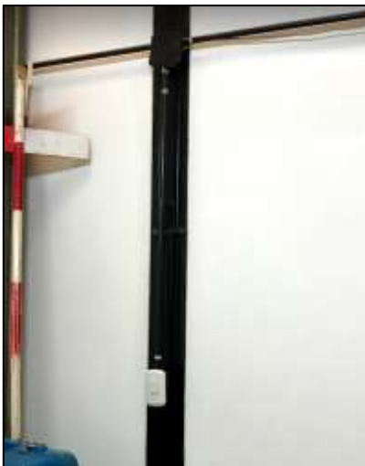
Fotografía 40. Instalación eléctrica del local, la cual como puede observarse es de hace varios años.
