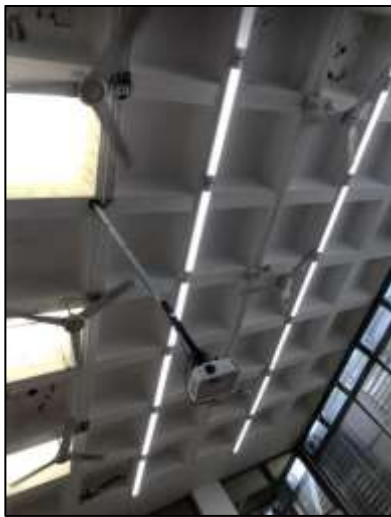
Fotografía 30. Elementos de refrigeración del local, en donde se aprecia los hongos y como se ha ido saltado la pintura del techo. En la imagen también se busca mostrar como los ventiladores tienen una velocidad determinada.
