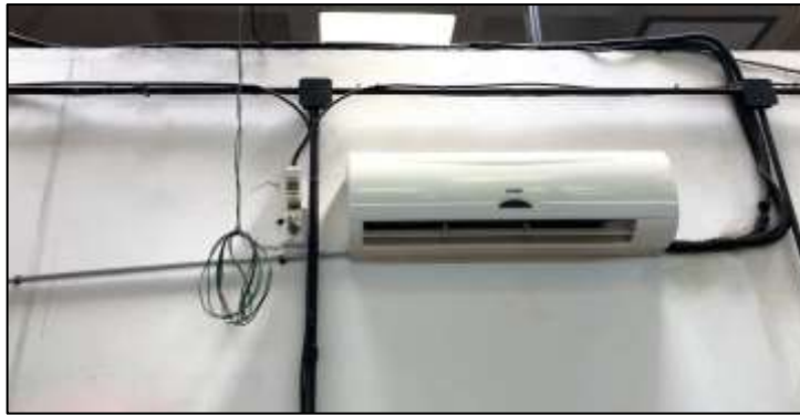
Fotografía 68. Conexión del aire acondicionado e instalación eléctrica del mismo.
