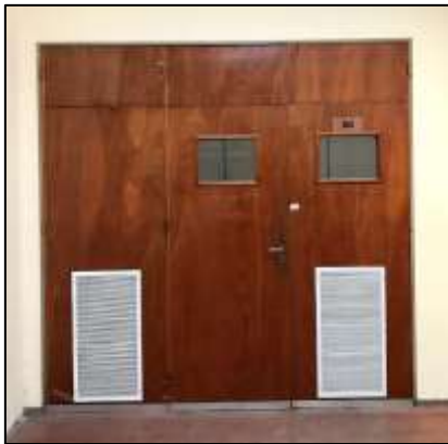
Fotografía 73. Puerta de ingreso del aula 104, la cual como se indicó anteriormente tiene reillas de ventilación en la parte inferior.
