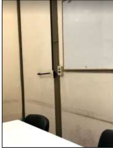
Fotografía 66. Instalación eléctrica de una de las esquinas, en donde se pone de manifiesta la cantidad de años de la misma.
