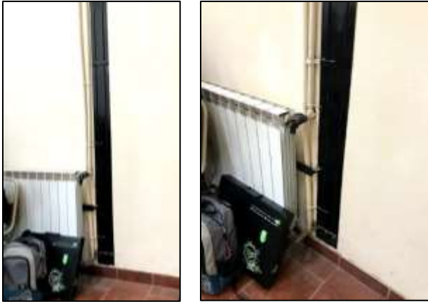
Fotografía 105. Cañería de agua del aula, y conexión con el radiador ubicada en una de las esquinas del salón.
