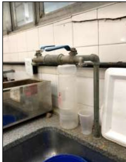
Fotografía 58. Bacha y grifería de otra de las mesadas, en donde se muestra como se disponen los elementos, la falta de limpieza y de mantenimiento de las mismas. Por ejemplo en este caso los cerámicos rotos de la pared.
