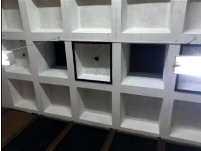
Fotografía 47. Techo del gabinete, en donde se presenta la luminaria del mismo y se puede ver como los tragaluces han sido cubiertos para evitar el paso de luz natural.
