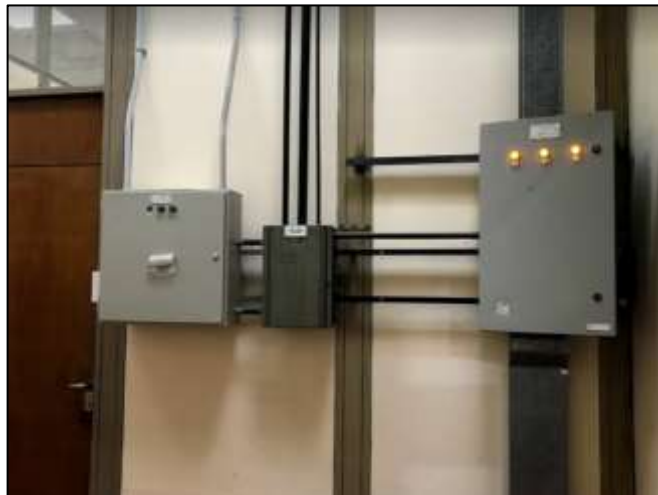
Fotografía 64: Tablero eléctrico del primer pasillo secundario, del nivel -1,35m.
