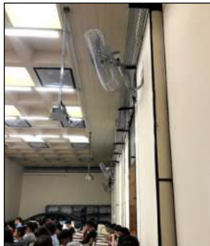
Fotografía 103. Ventiladores, proyectores, bandeja metálica, luces led y tragaluces del aula.
