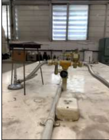
Fotografía 56. Parte de la instalación eléctrica y de gas de la mesada, en donde se puede observar la campana de extracción en la esquina del laboratorio y los elementos de protección (parasoles y paneles) de las ventanas.
