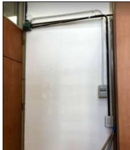
Fotografía 31. Instalación eléctrica antigua y nueva, en donde se ve los diferentes materiales empleados (aspectos físicos y color).
