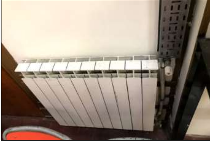
Fotografía 96. Instalación de agua, y parte de la conexión con el radiador.
