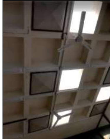
Fotografía 101. Techo del local en donde se aprecia la distribución de luces led, los ventiladores y la disposición de los tragaluces. Un hecho destacable, es como ingresa luz a través de los paños fijos del aula y la claridad que genera.
