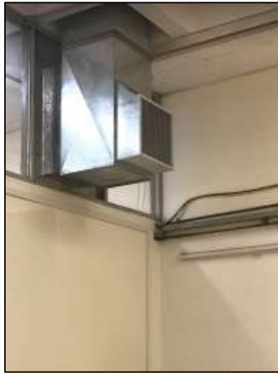
Fotografía 72. Tubería de ventilación del salón, la cual posee importantes dimensiones.
