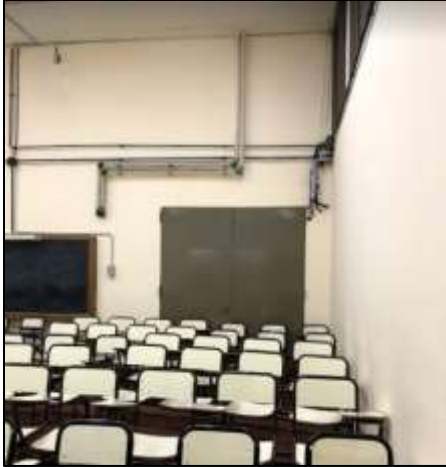
Fotografía 75. Parte de la instalación eléctrica y de agua del salón, las cuales tienen varios años. Se presenta también la puerta del fondo del salón, la cual no puede abrirse.
