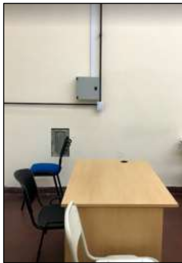
Fotografía 76. Se muestra la instalación eléctrica (nueva y vieja), además se puede ver el tablero eléctrico dispuesto en el salón para encender el proyector.
