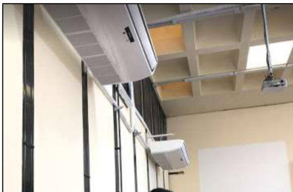
Fotografía 49. Se presenta la distribución y conexión de los aires acondicionado en el aula y la disposición de la iluminación natural y artificial (formada por las luces led).
