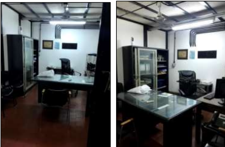
Fotografía 13. Se presentan las dimensiones de la secretaria, la disposición de los elementos que la constituyen como así también la instalación eléctrica del local con su medio de refrigeración actual.
