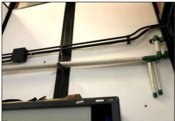
Fotografía 41. Instalación eléctrica del box, en donde se observa el estado de las conexiones. Además también se observa unas cañerías de agua, que atraviesan el local.
