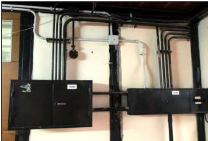
Fotografía 4. Tablero eléctrico del pasillo secundario 4, en donde se aprecia la conexión eléctrica nueva y la más vieja (esta se diferencia por los materiales que lo constituyen).
