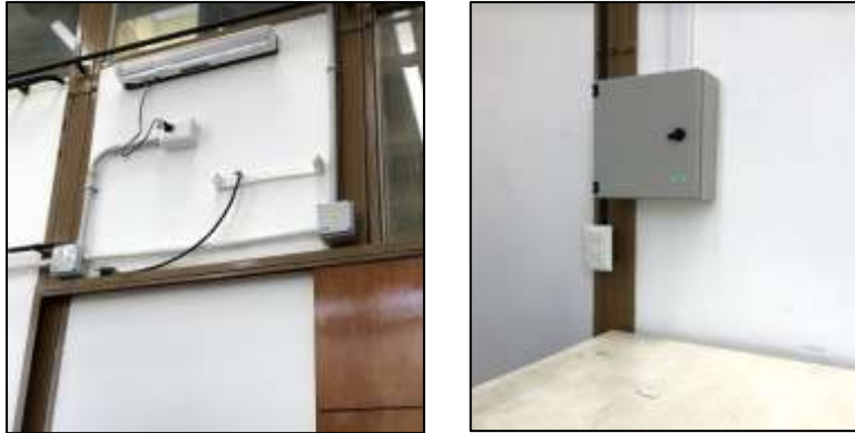
Fotografía 9. Instalación eléctrica, donde se observa la parte nueva de la conexión (de color blanco) y la parte antigua (de color negro). Se indica también el tablero eléctrico del aula y la luz de emergencia.
