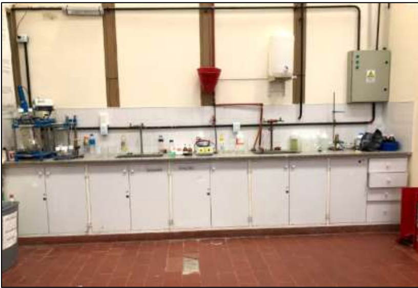
Fotografía 57. Imagen de la bacha y grifería de una de las paredes perimetrales del aula, en donde se puede ver la instalación eléctrica, el tablero y los medios de protección por posibles accidentes (matafuego y balde con arena). En la parte inferior de la mesada se guardan sustancias químicas y otros elementos.
