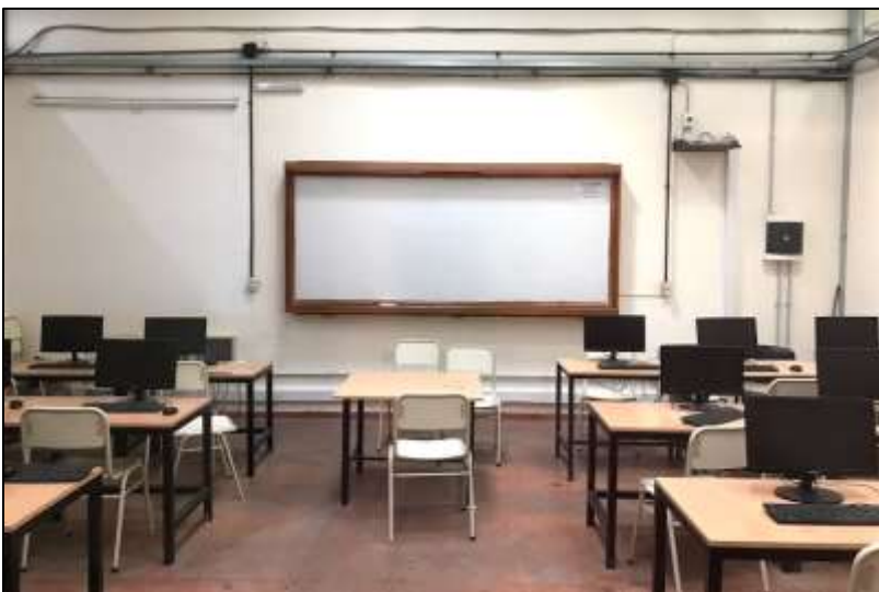
Fotografía 70. Distribución de los bancos y presentación de la conexión eléctrica (parte nueva y más antiguas).
