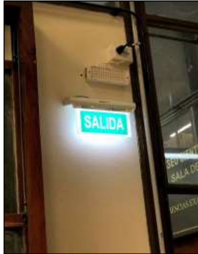
Fotografía 99. En la imagen de la izquierda se muestra parte de la conexión eléctrica nueva, que se utiliza para encender las luces y ambos ventiladores. Mientras que en la imagen derecha se presenta la luminaria de salida y en el caso de emergencia.
