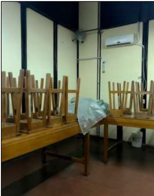
Fotografía 45. Otra de las esquinas del local, en donde se ve la ubicación y conexión del segundo aire acondicionado, el segundo ventilador del gabinete, conexión eléctrica y de agua.
