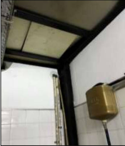
Fotografía 17. Material utilizado en el techo del baño, el cual está constituido por dos elementos: telgopor y acero.
