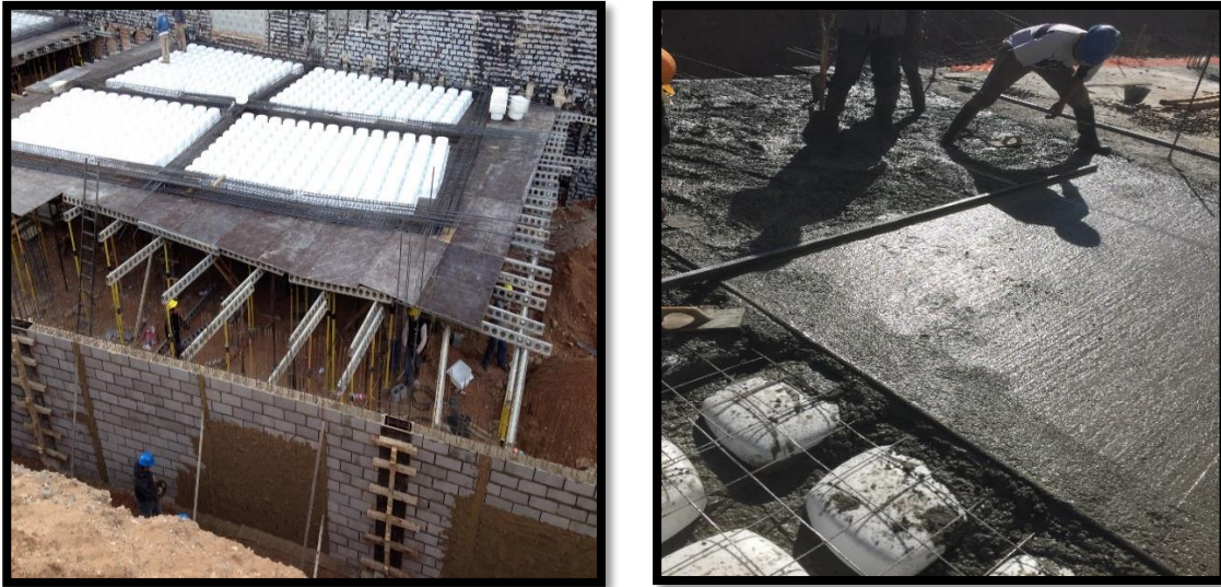
Figura N°19. Armado de losa nervurada con casetones recuperables. Hormigonado de la misma, vibrado y "regleado" del hormigón
