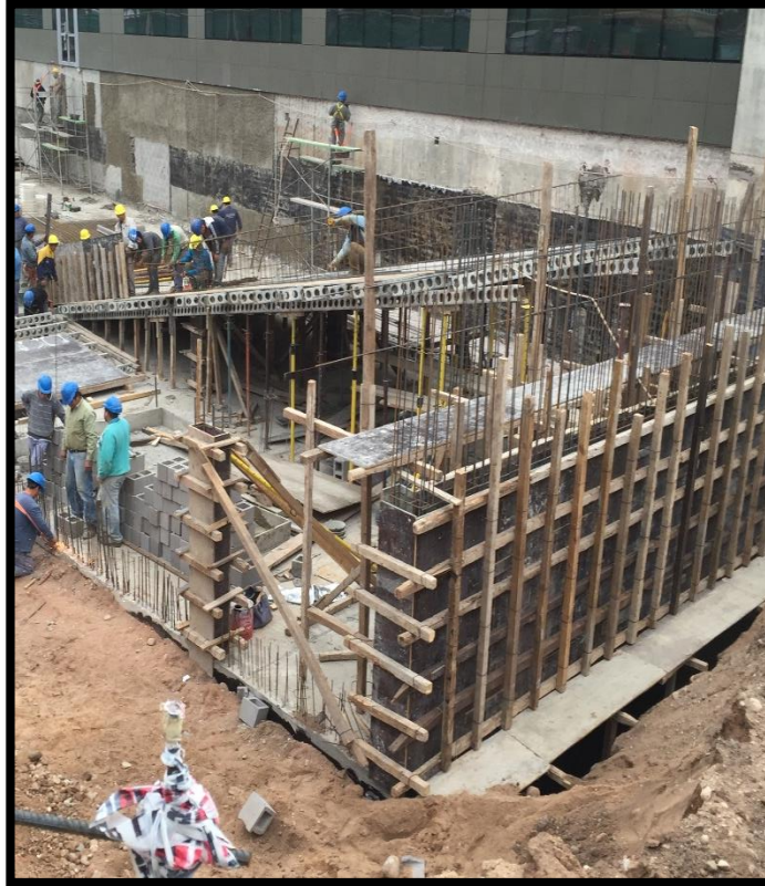
Figura N°11. Tabique de hormigón armado sobre losa de primer subsuelo. Encofrado y llegada de rampa vehicular
