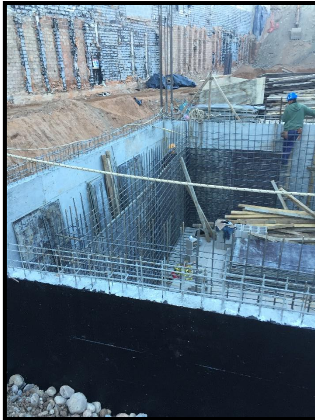
Figura N°14. Cisterna y cáscara de la misma
