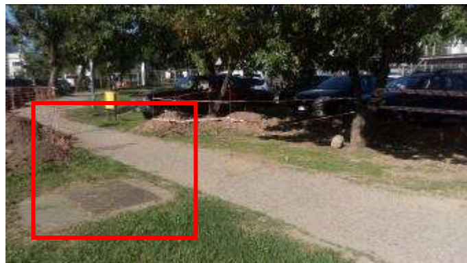
Figura 7 – Cámara Subterránea de Servicios. Fuente: Fotografía.
