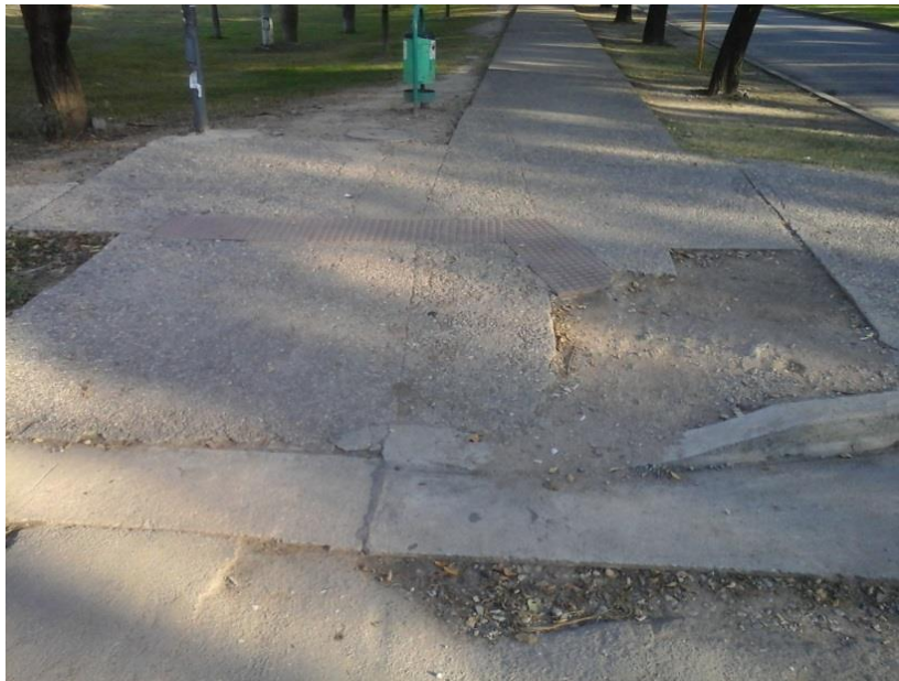
Figura 5.36: Rampas para discapacitados actuales en mal estado
