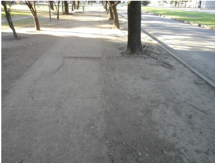
Figura 5.21: Estado actual de veredas ubicadas al Oeste
