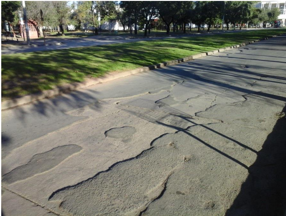
Figura 5.5: Zona con recapado de concreto asfáltico totalmente deteriorado
