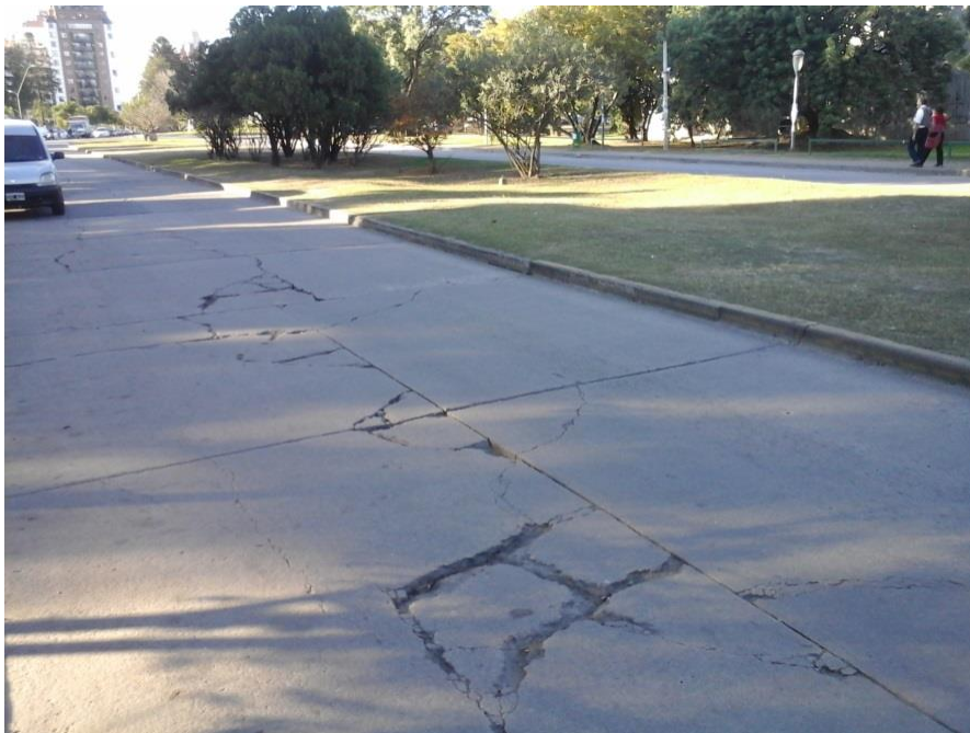
Figura 5.4: Losas de Hormigón en mal estado
