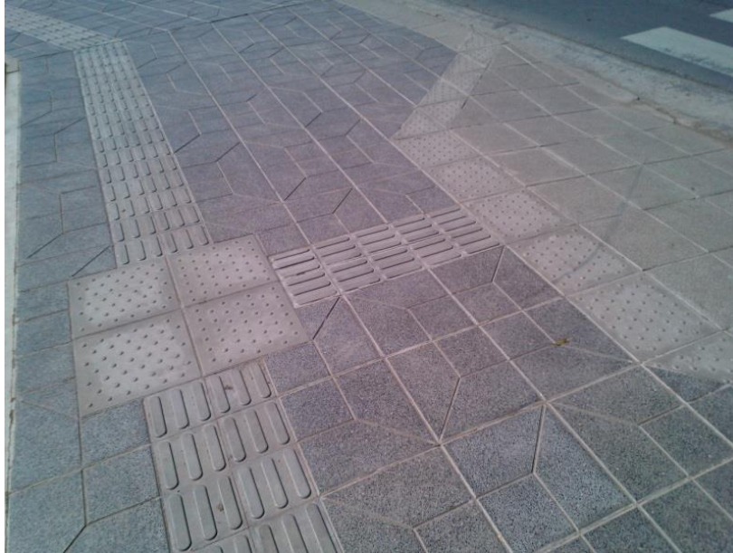
Figura 5.24: Losetas tipo Vainilla conformando las fajas y Losetas de alerta tipo Botones en los cambios de dirección e inicio de rampa (Parque Las Tejas)
