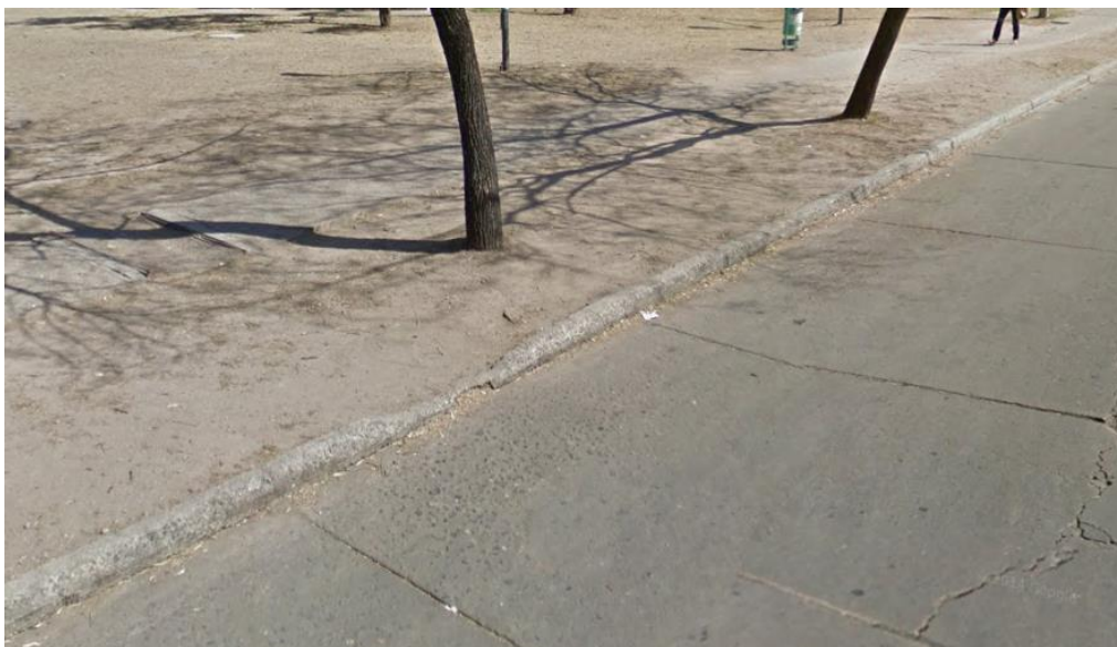
Figura 5.6: Cordones externos deteriorados
