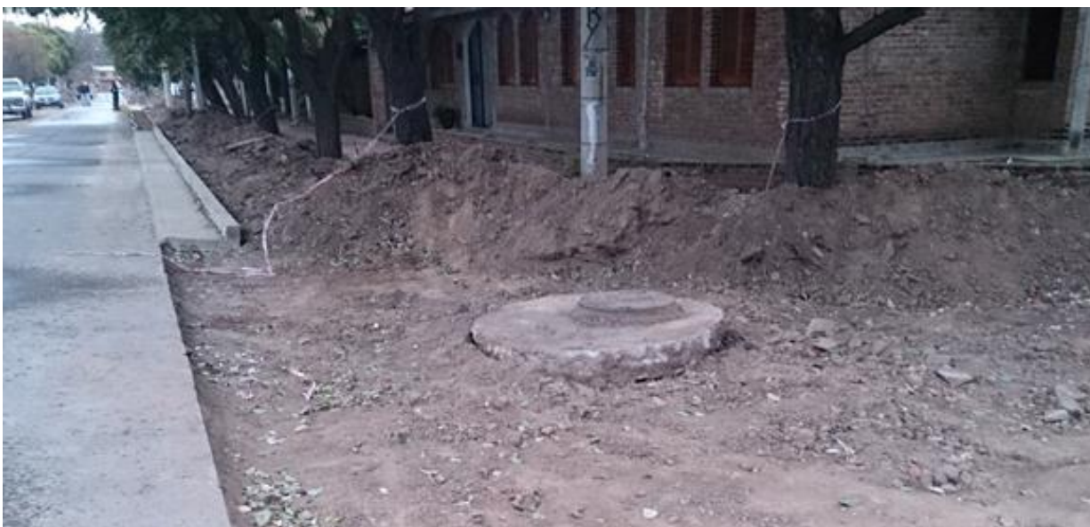
Figura 4.6: Bocas de registro de cloacas.
