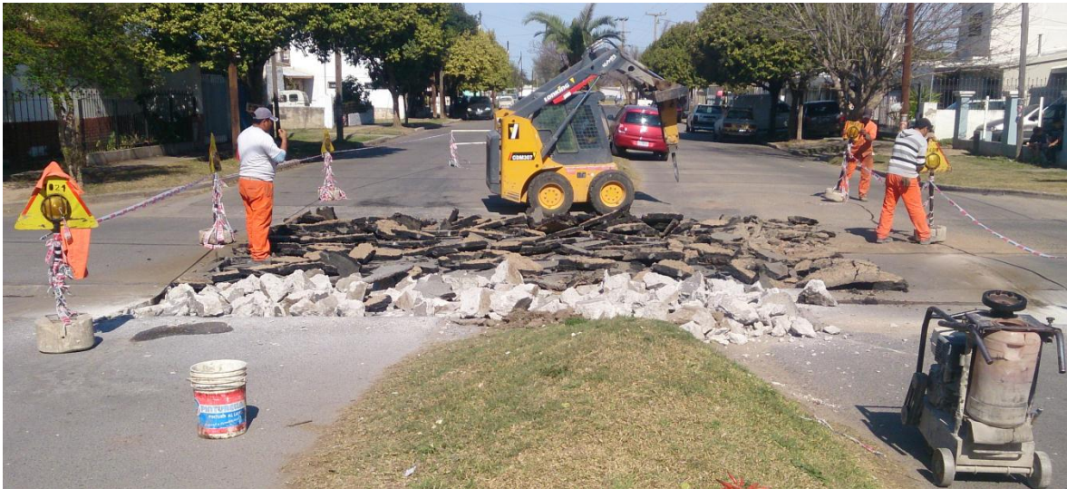
Figura 4.18: Rotura de pavimento flexible.
