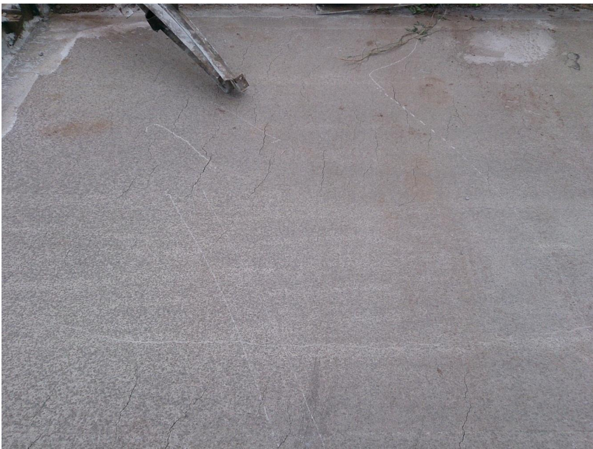
Figura 4.19: Fisuras en el hormigón.
