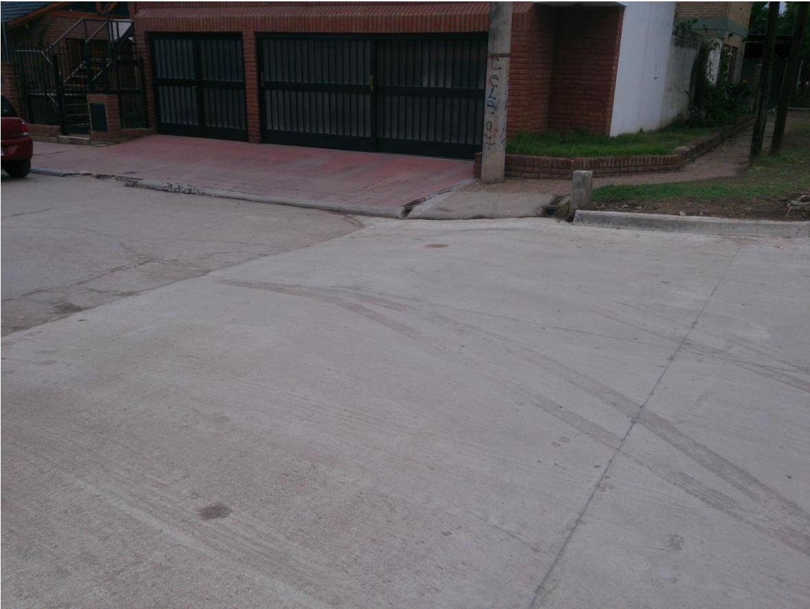
Figura 4.16: Marcas producto de la circulación de vehículos.
