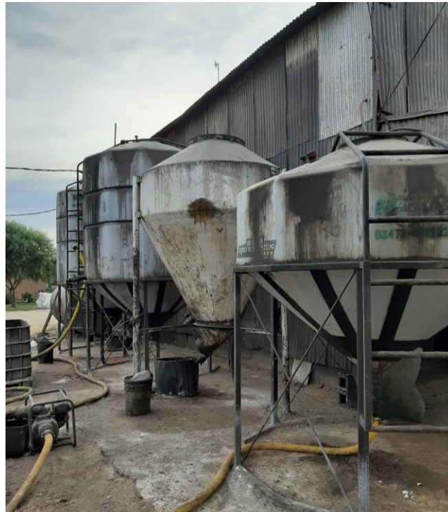
Figura 20: Tanque de almacenamiento.
