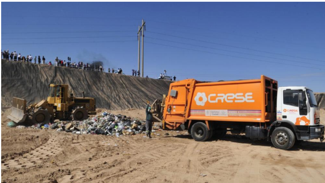
Imagen 2.4. Predio de enterramiento sanitario en Córdoba
