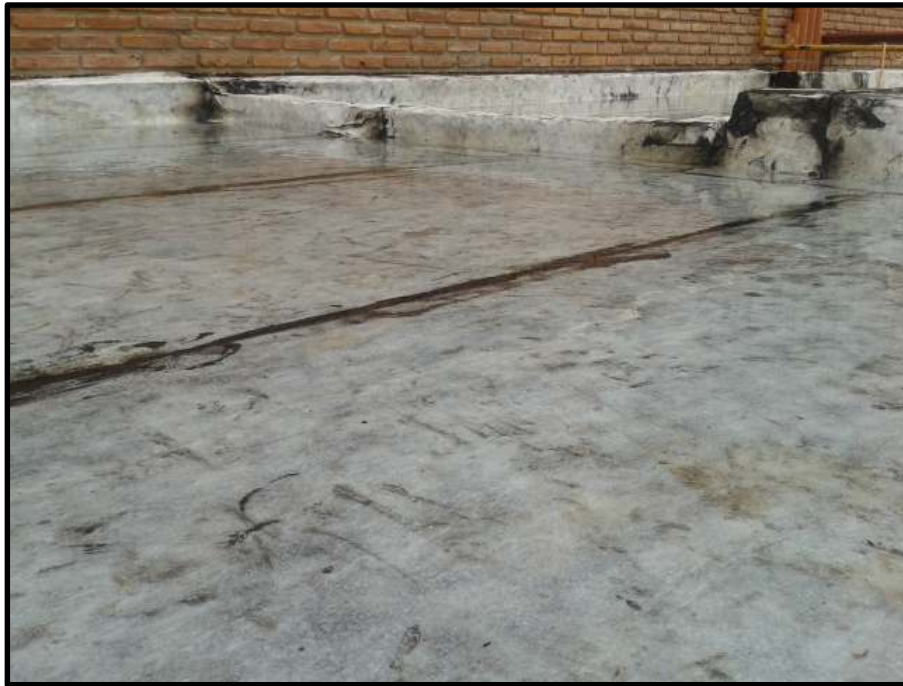
Azotea llena de agua
