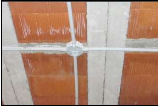
Canalización P.B., caños de P.V.C. rígidos.
