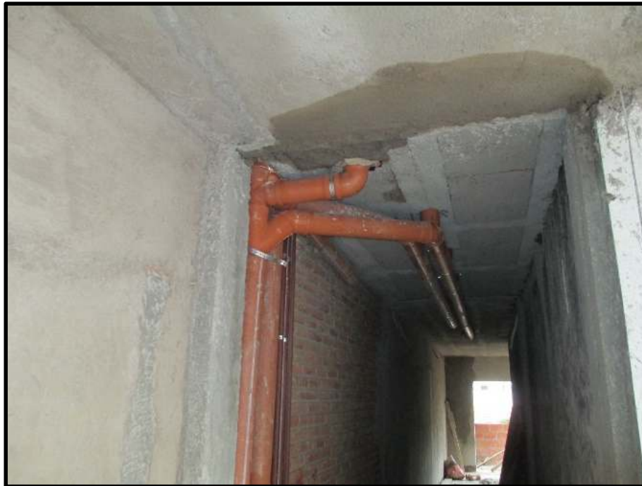
Identificación de una filtración en zona de embudo
