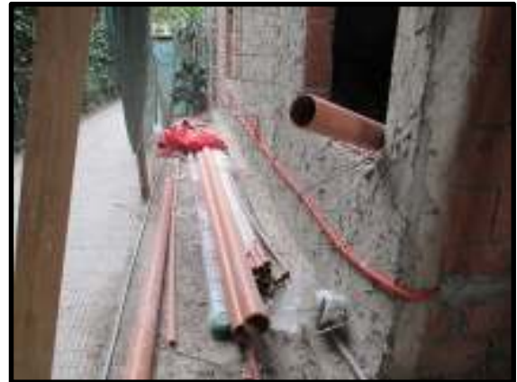
Canalización, corrugado flexible.
