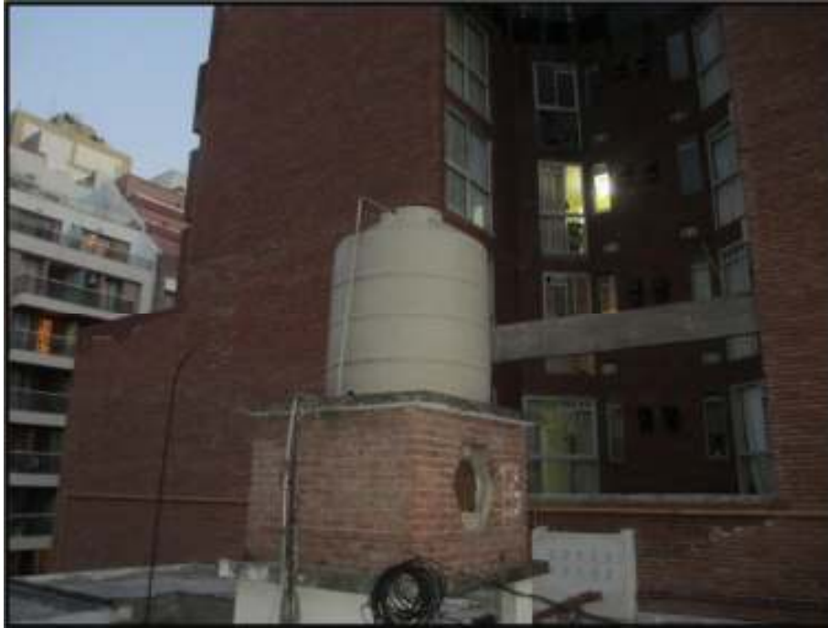
Tanque de agua existente
