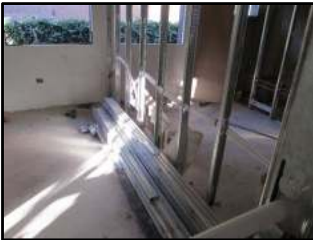
Canalización Dormitorios P.A., Caño corrugado Flexible.
