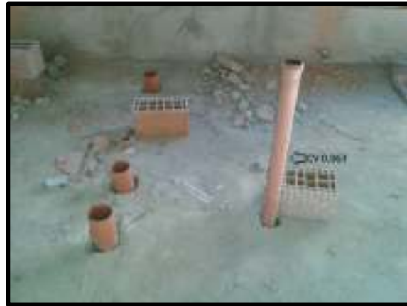
Conducto de ventilación baño
