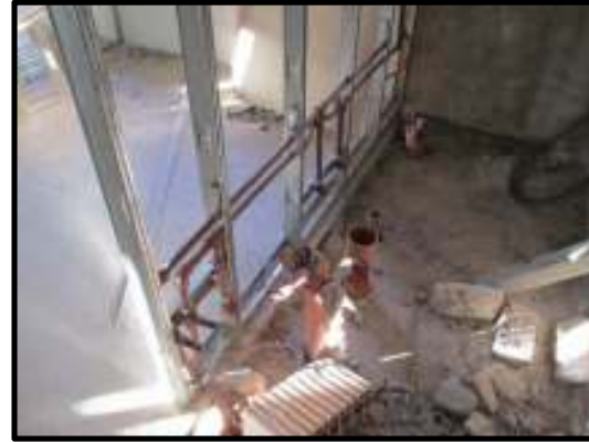
Tubería de baños de planta alta
