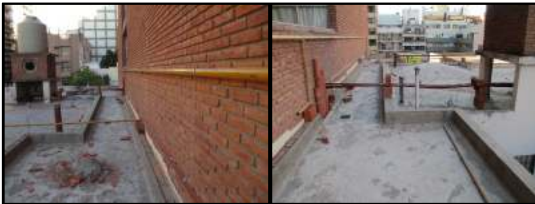
Cañería Principal de gas, ubicada en la Azotea.
