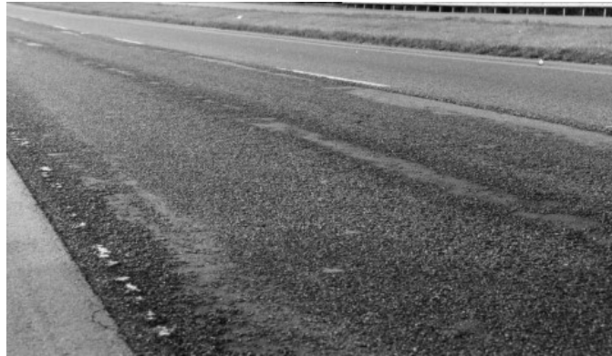
Figura 7.21: Desprendimientos de asfalto
