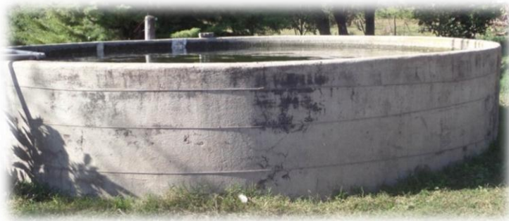
Figura 16: Tanque de almacenamiento de agua libre de malezas en su alrededor.
