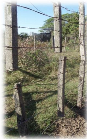
Figura 5: Alambrado con presencia de varillas rotas e hilos flojos.
