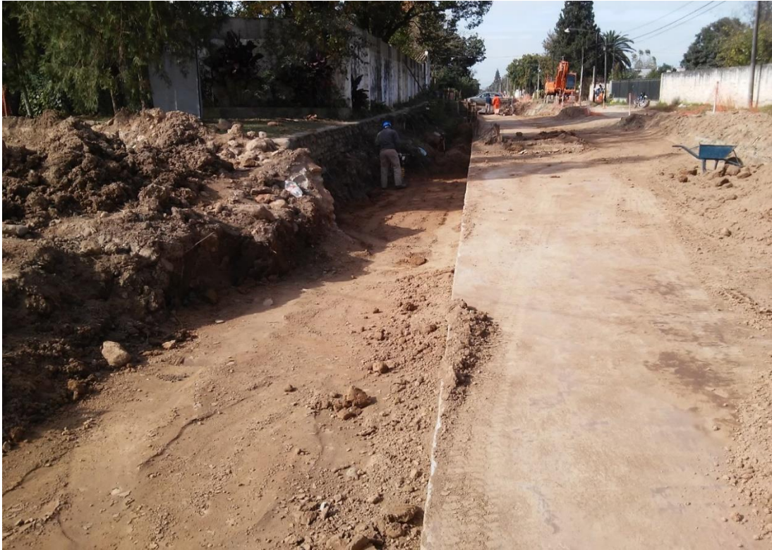
Figura N°2-12: Compactación de los laterales. Se puede apreciar la realización de trabajo en uno de los márgenes.
