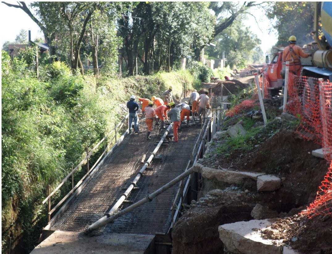
Figura N°4-11: Losa: Hormigonado con bomba. Se observa el uso de tuberías, debido a la imposibilidad de llegar con el mixer.
