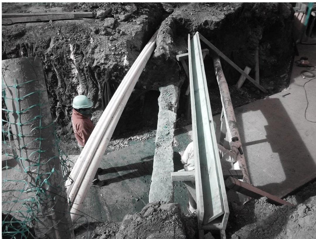
Figura N°3-17: Foto de la estructura de paso proyectada y el conducto que contiene la línea de media tensión. EDET RD-L.
