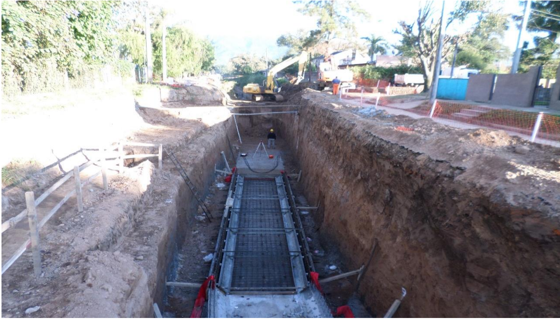
Figura N°4-4: De arriba hacia abajo, se observa un tramo de H-8, un módulo con la armadura de solera lista, y uno con la solera ya hormigonada.
