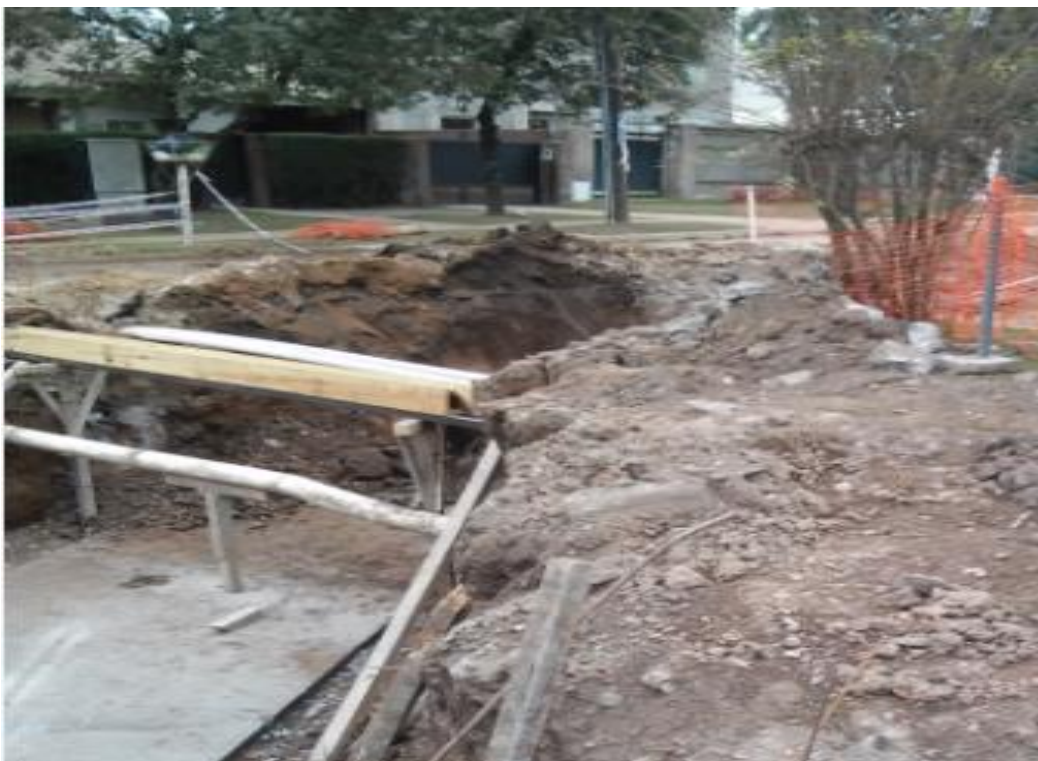
Figura N°3-16: Foto de la estructura de paso proyectada y el conducto que contiene la línea de media tensión. EDET RD-L.
