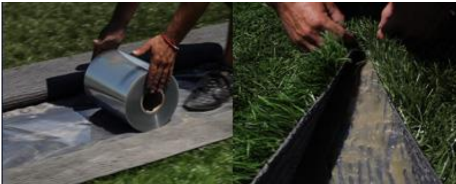
Figura 10: Extensión de la cinta metálica y pegado de las piezas de césped sintético
