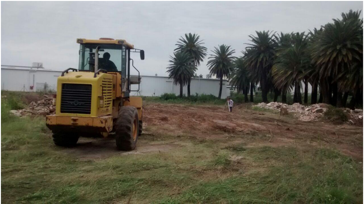
Figura 21: Imagen del terreno, la cargadora siguiendo con la limpieza y al fondo se observa el inicio del relevamiento topográfico del terreno.
