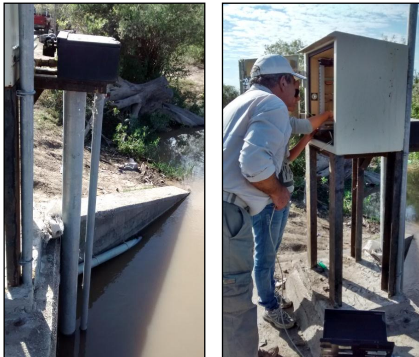
Figura 66. Estructura soporte del instrumental.
