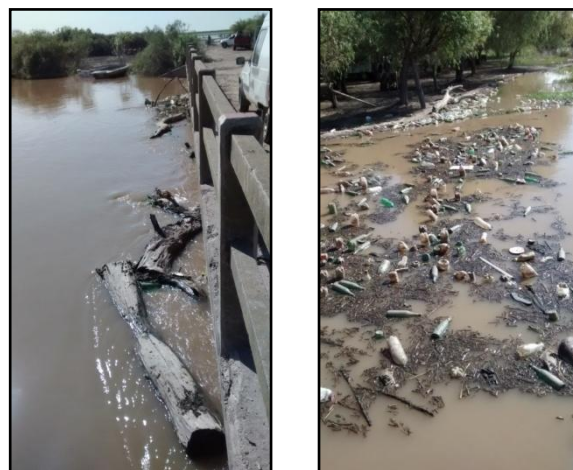
Figura 98. Flujo obstruido por el puente en Paso de la Cina
