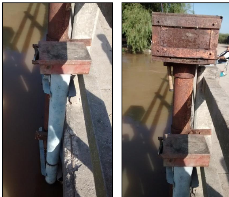
Figura 62. Estructura soporte del instrumental.
