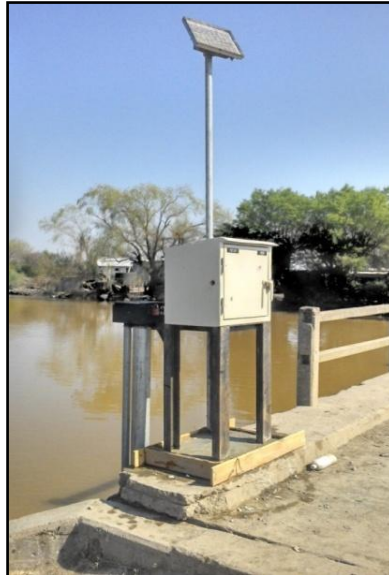
Figura 52. Estructura instalada en Paso de la Cina sobre la margen este de la sección.
