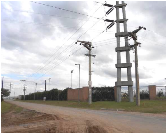
Figura 41: Intersección calles Cañada de Gómez y Colonia Impira. Se observan líneas de media y alta sobre C. Gómez.
