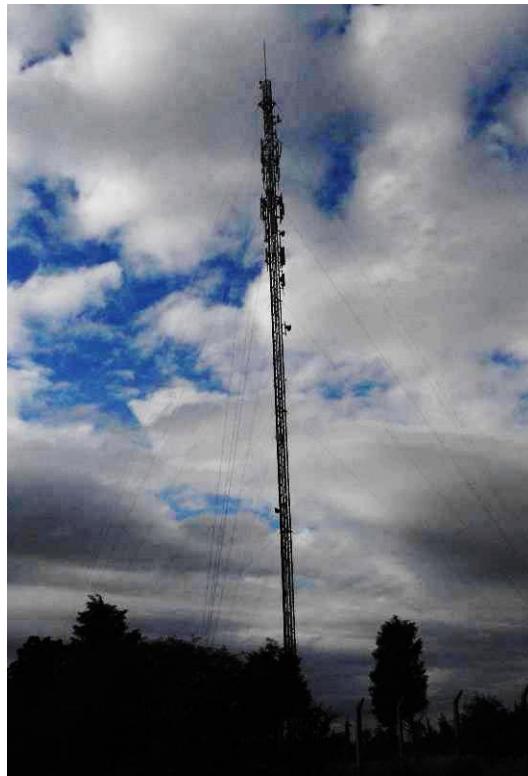
Figura 48: Antena de telefonía celular.
