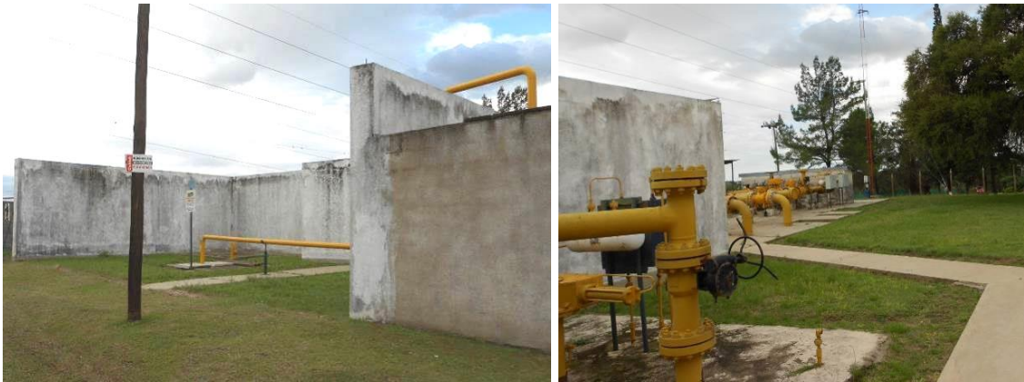
Figura 46: Planta reductora reguladora de presión.
