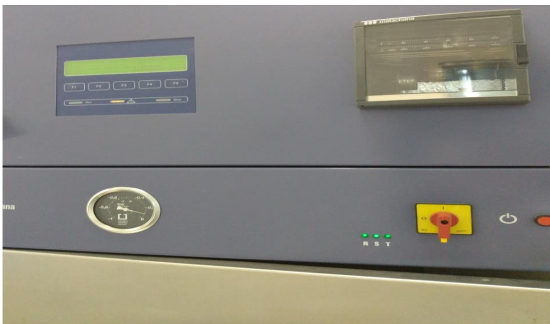
Foto 15: Equipo Esterilizador FHO en funcionamiento
