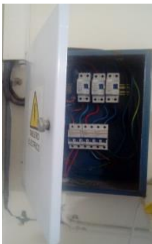
Instalación eléctrica, llaves térmicas
