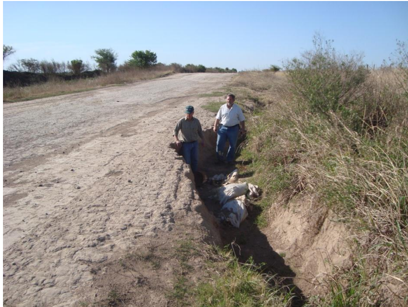
Figura 16: Erosión en cunetas de camino.
