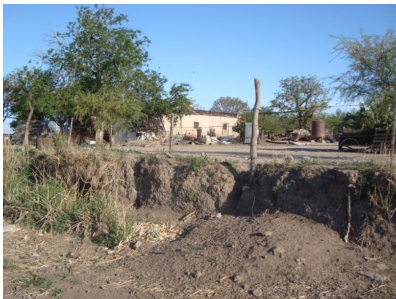
Figura 21: Casa en riesgo por erosión de camino.
