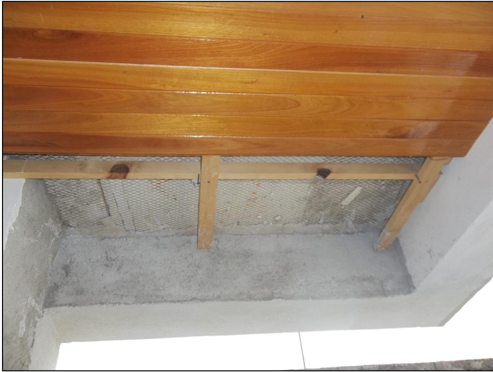
Figura 32: Cielorraso de madera en balcones.
