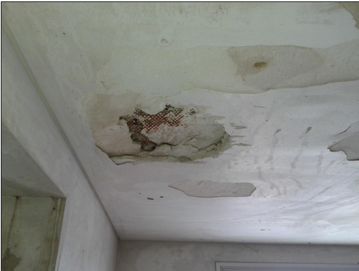
Figura 60: Deterioro en cielorraso de yeso por filtraciones de agua de lluvia.
