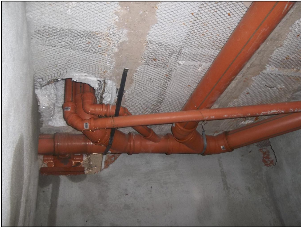
Figura 33: Cañería sanitaria suspendida asegurada a la losa con grampas.
