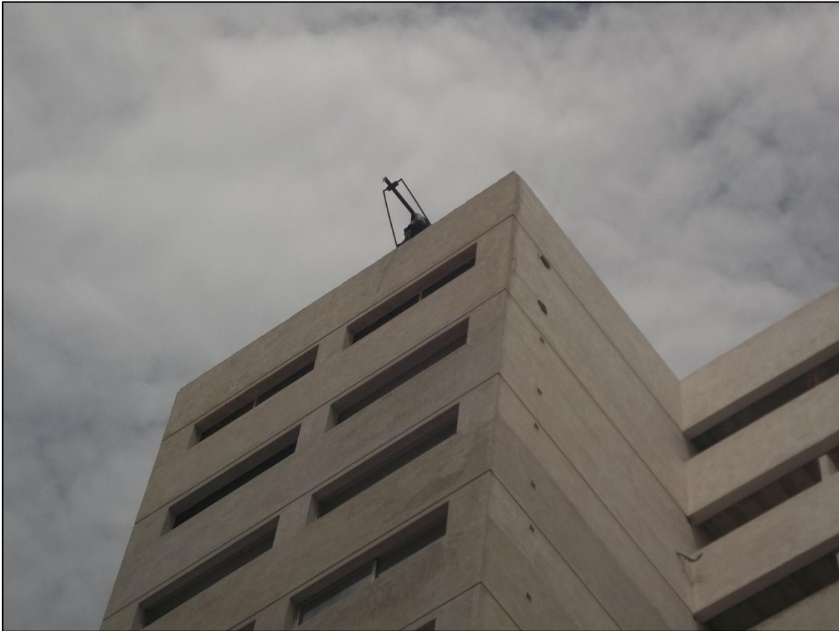
Figura 36: Aparejo eléctrico montado en la azotea sobre una estructura tubular.
