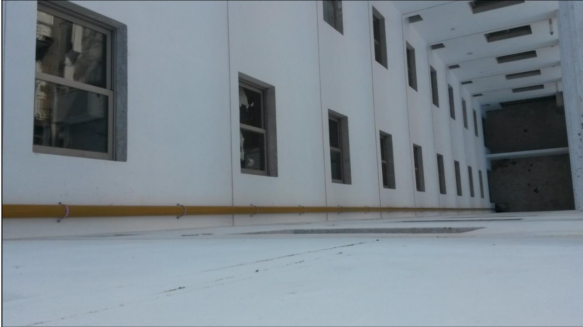
Figura 38: Cañería de gas engrampada en su recorrido por patio de luz hacia nichos.
