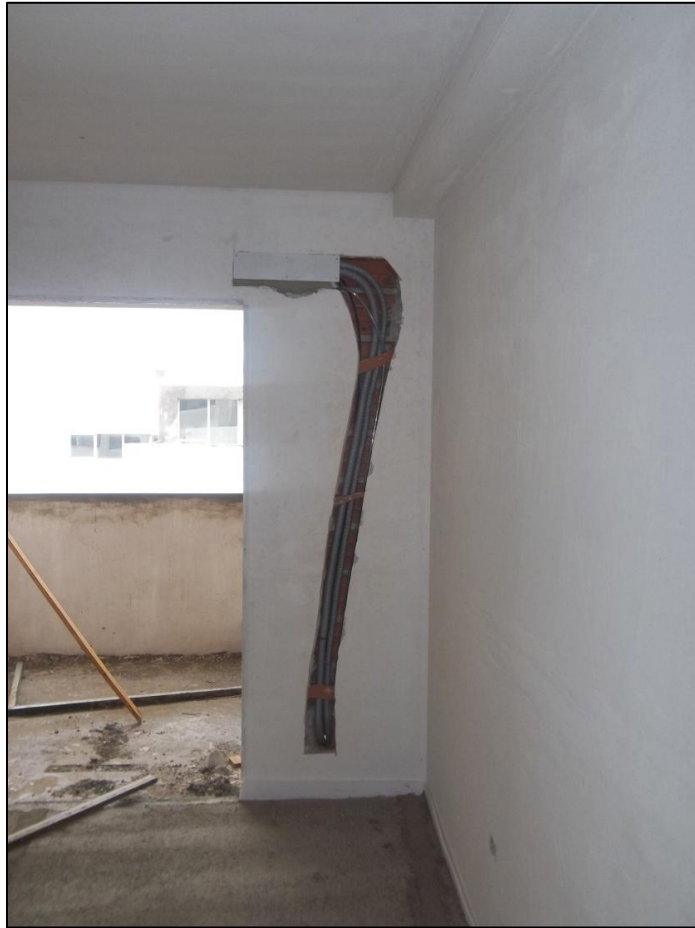
Figura 49: Caja de preinstalación para aire acondicionado.
