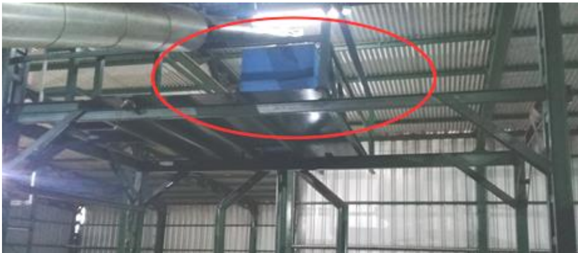
Figura 18: Tolva distribuidora de granos en la empresa Barbieri.
