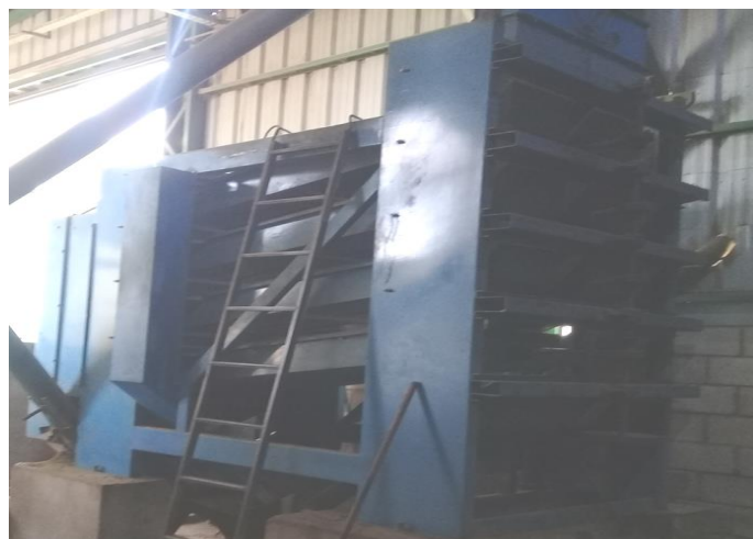
Figura 12: Sistema de limpieza de tipo zarandas en la empresa Barbieri.
