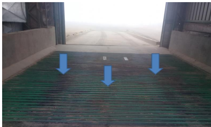
Figura 11: Rejilla de descarga en la recepción de granos de la empresa Barbieri.
