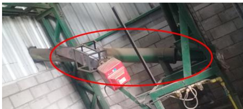
Figura 14: Quemador a gas para el calentamientos del sistema de conducción de granos en la empresa Barbieri.
