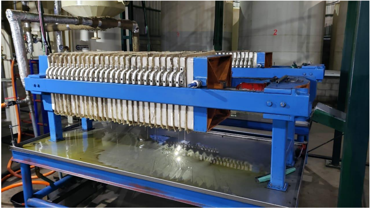
Figura 28: Equipo de filtrado FQ-10 de aceite y tanques de depósito final en la empresa Barbieri
