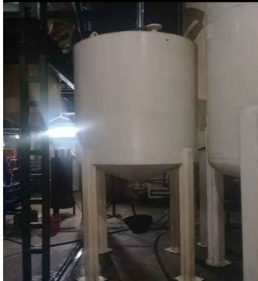
Figura 30: Tanque intermedio de decantación como parte del sistema de filtrado de aceite, en la empresa Barbieri
