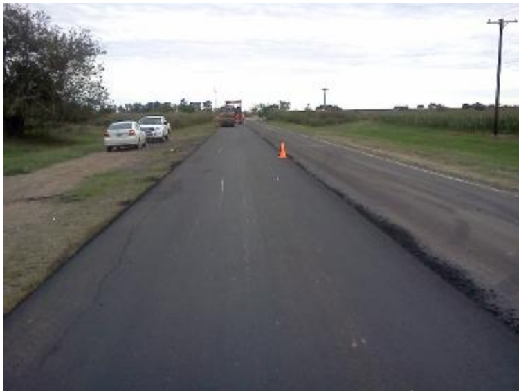
Figura 128 ZONA DE FISURA IMPORTANTE REFLEJADA
