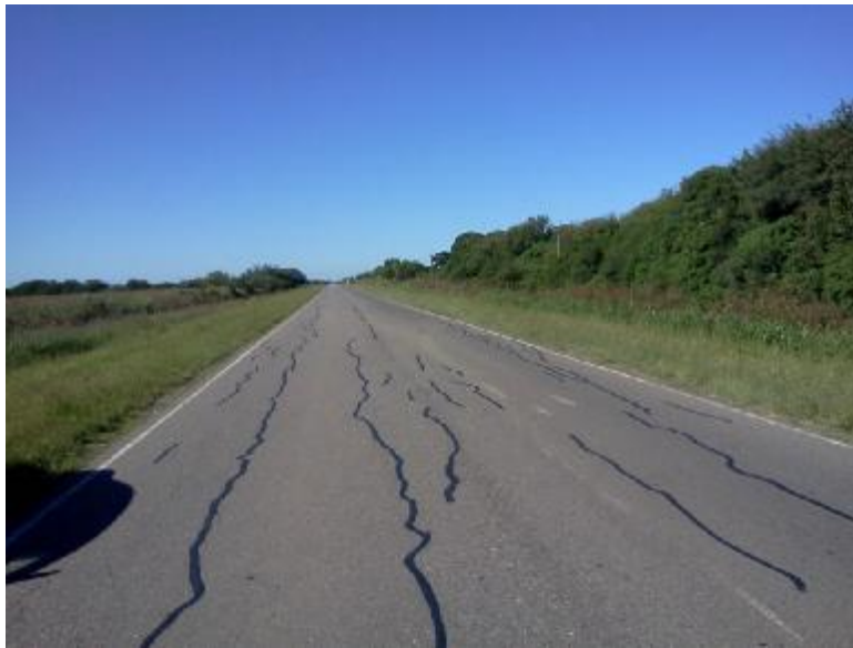
Figura 120 TOMADO DE FISURAS
