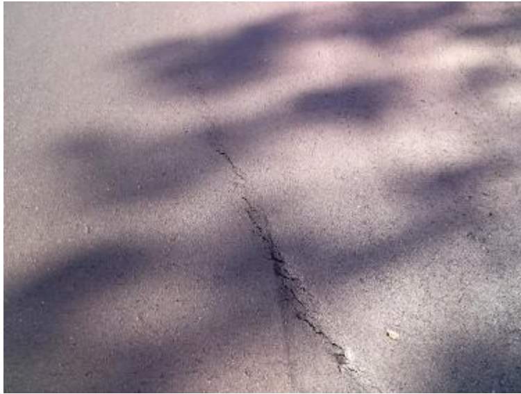
Figura 127 FISURAS EN LA CARPETA ASFALTICA NUEVA
