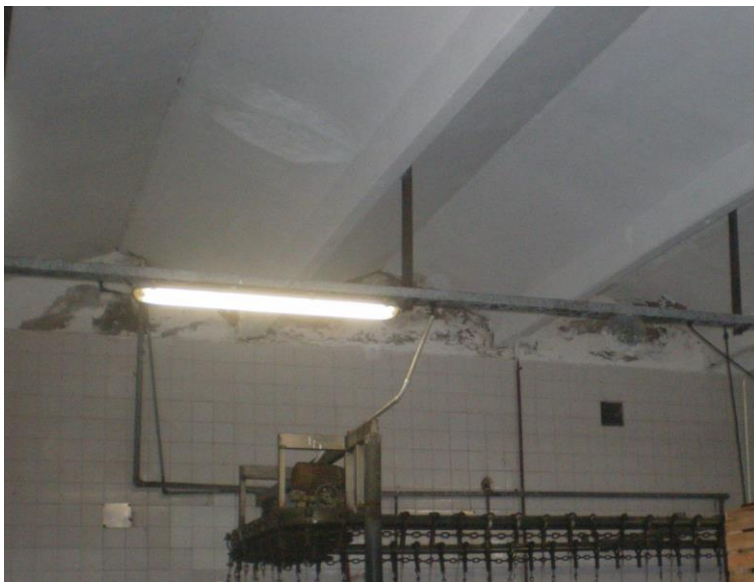
Figura 22: Parte de los techos se encuentran descascarados con peligro de desprendimiento
