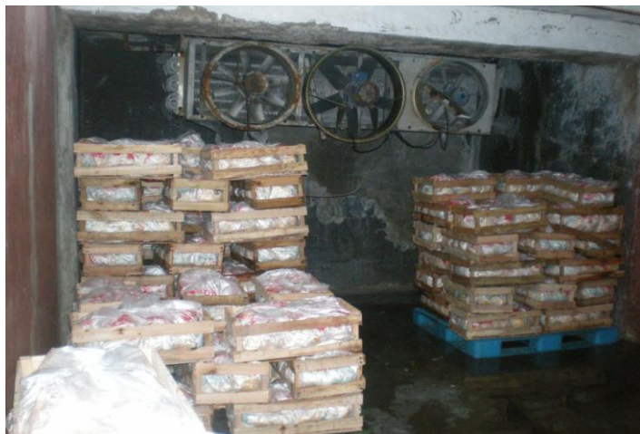
Figura 21: Cámara de refrigerado
