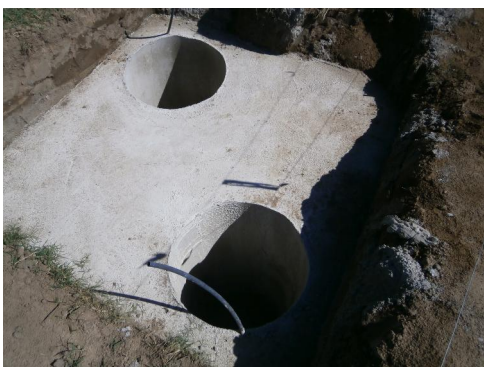
Fotografía N°5 Base finalizada lista para recibir los postes de hormigón armado pretensados. En este caso es una estructura doble ya que resiste cargas elevadas.
