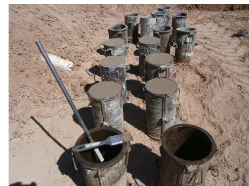
Fotografía N°6 Probetas que se realizan a pie de obra para verificar la resistencia del hormigón.
