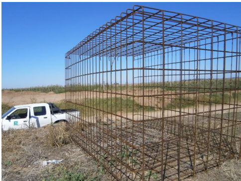
Fotografía N°3 Armadura calculada a colocar dentro de la excavación sobre el hormigón de limpieza con separadores laterales y de fondo.
