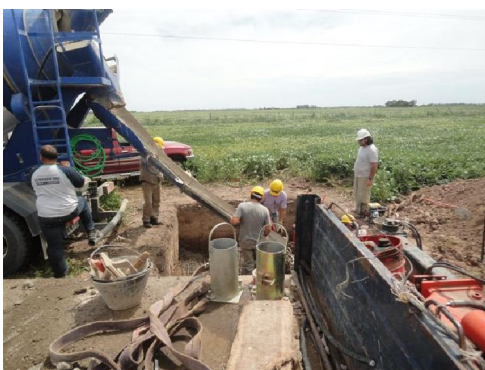
Fotografía N°11 Vertido de hormigón. Aquí vemos como se llena la platea desde una altura pequeña para evitar la segregación.
