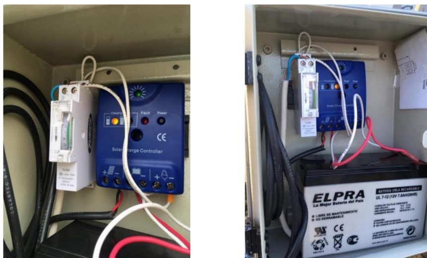
Figura 15: Fotografías del controlador horario conectado al regulador de carga dentro del gabinete IP65.
