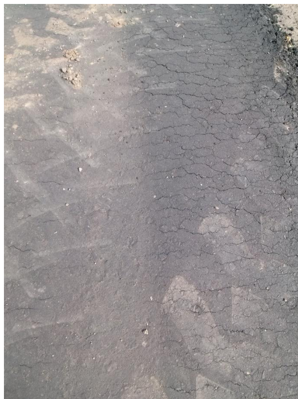
Figura 36: Bache sobre Carpeta Asfáltica
