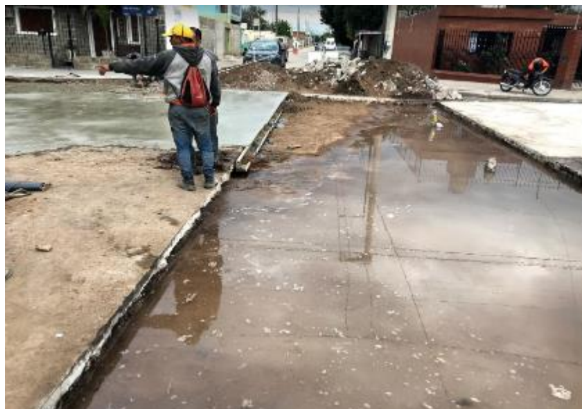
Figura 26. Bache inundado por cañería dañada.
