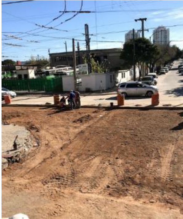
Figura 48. Rotura de aleta frente a la estación de Trolebuses
