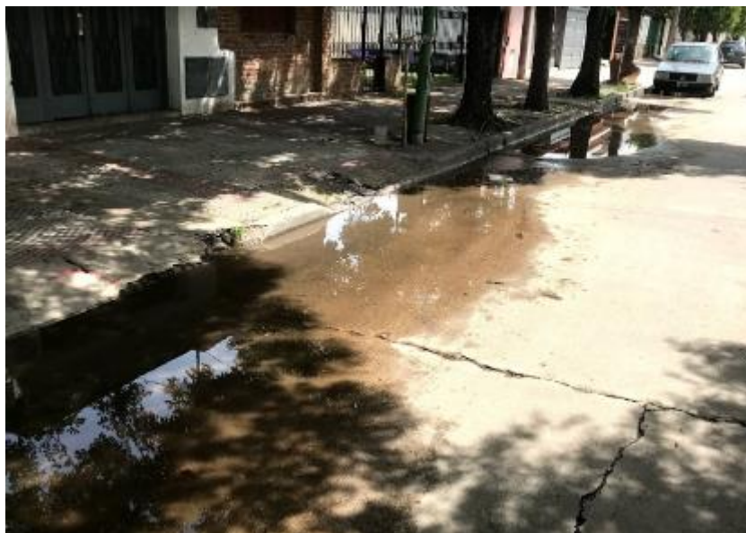
Figura 7. Calzada con problemas de pendiente
