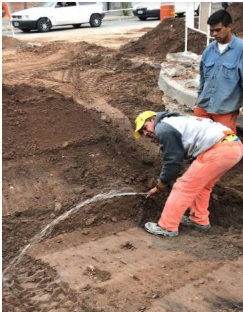
Figura 25. Conexión clandestina de agua rota.
