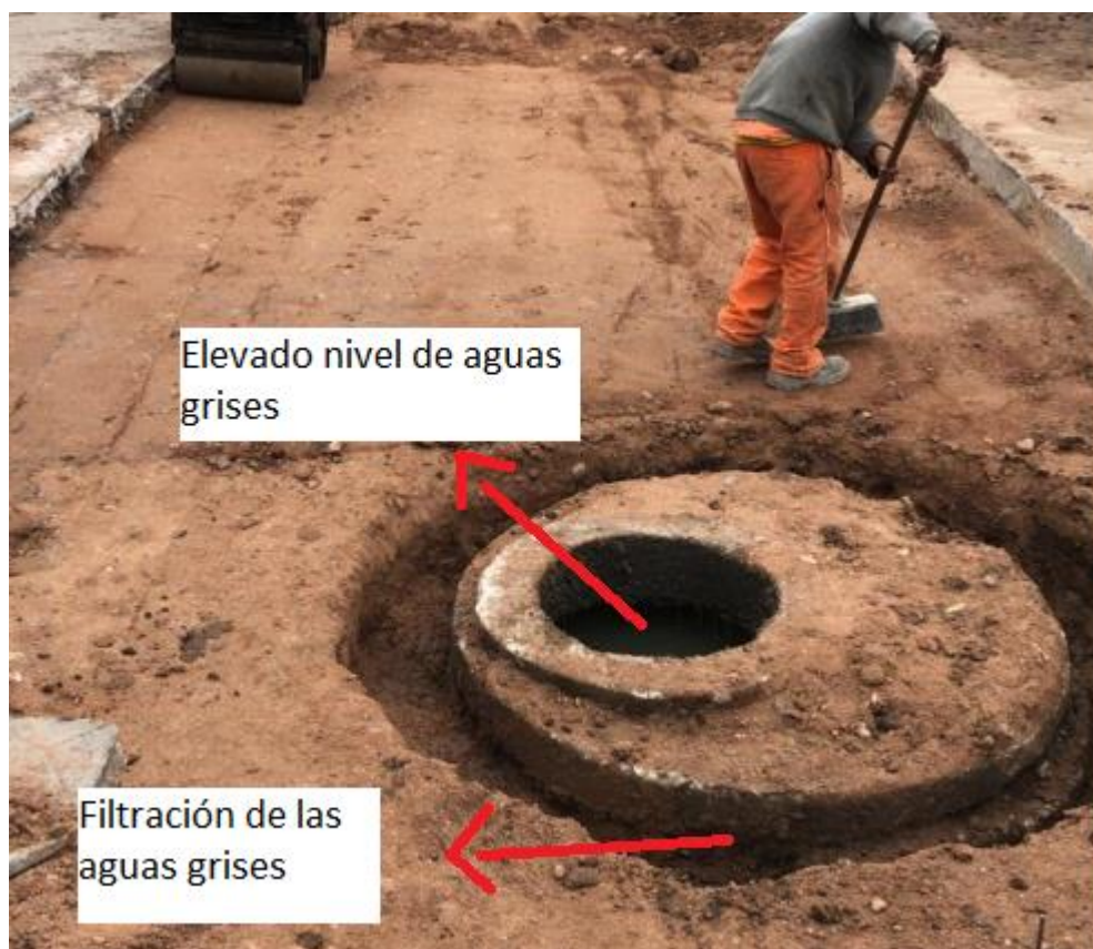
Figura 49. Arreglo de pérdida de aguas grises
