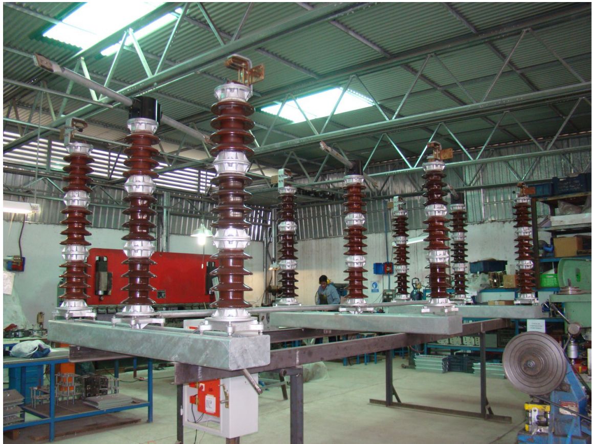
PRUEBA DE SECCIONADORES EN FABRICA
