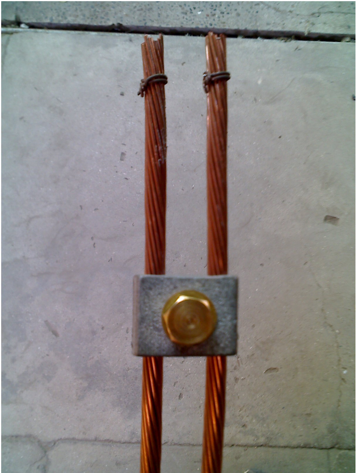
DETALLE DE BLOQUETE DE PUESTA A TIERRA
