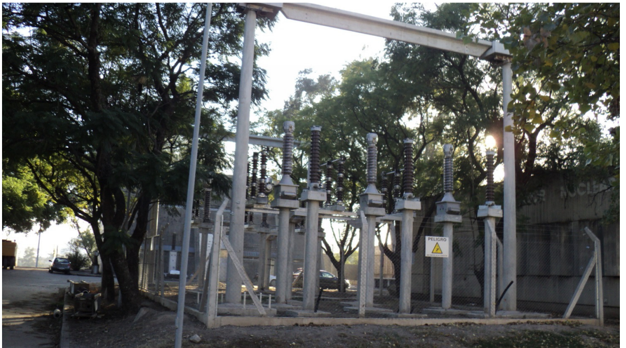
CAMPO CON EQUIPOS MONTADOS
