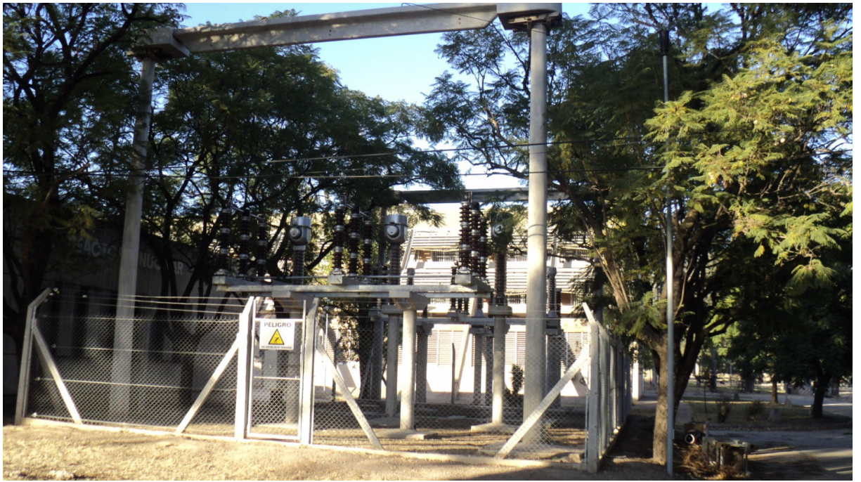
CAMPO CON EQUIPOS MONTADOS
