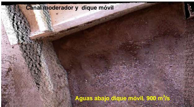
Fig. 7: Foso de erosión aguas abajo del dique móvil. Imagen RGB.
