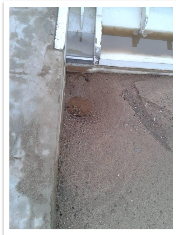
Figura 71: Fosa de erosión aguas abajo de CM con Q=100 \text{ m}^3/\text{s}
