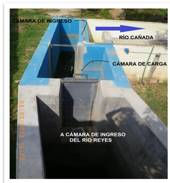
Figura 12: Cámara de carga del río Reyes.
