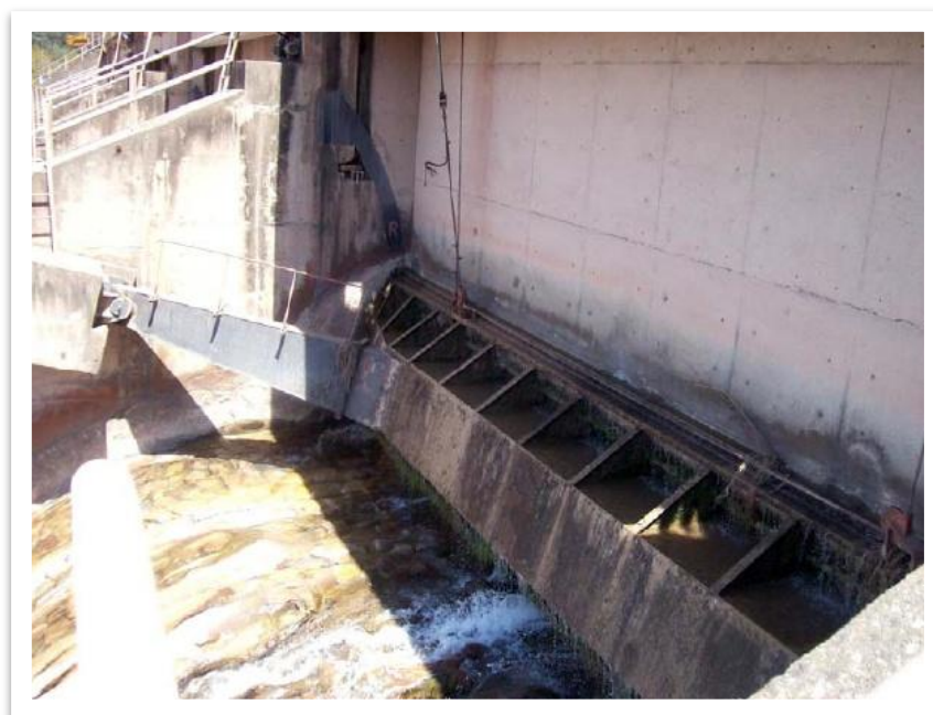
Figura 7. Falta de mantenimiento. Problema en las juntas del Dique Móvil (DM).
