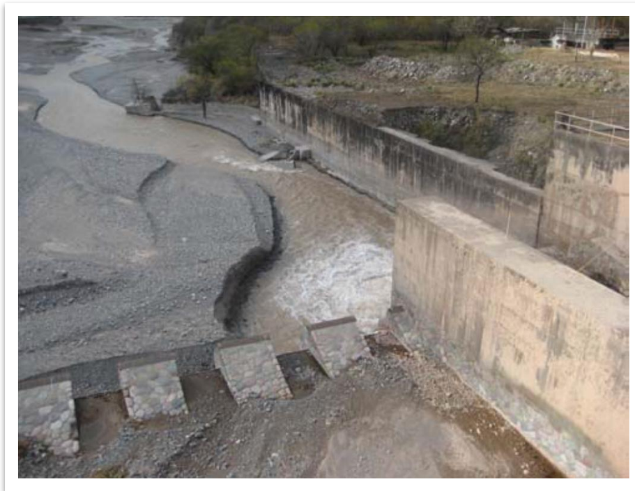
Figura 6. Erosión en el perfil del vertedero del Canal Moderador (CM)
