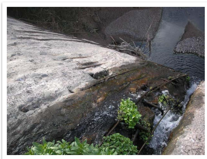
Figura 5. Erosión en el perfil del vertedero del Dique Fijo
