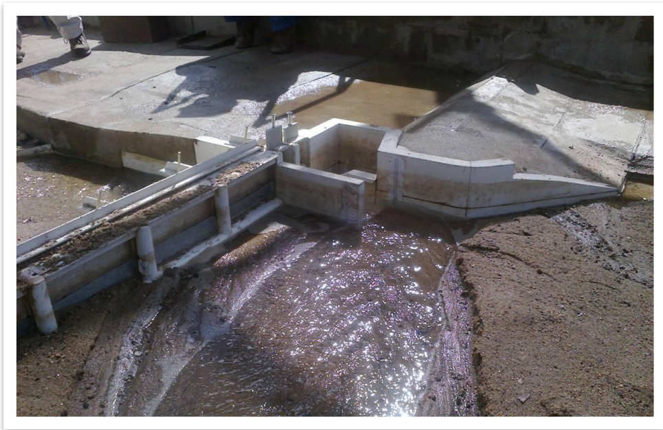
Figura 63: Detalle de zona aguas arriba de la obra con Q=75 \text{ m}^3/\text{s}
